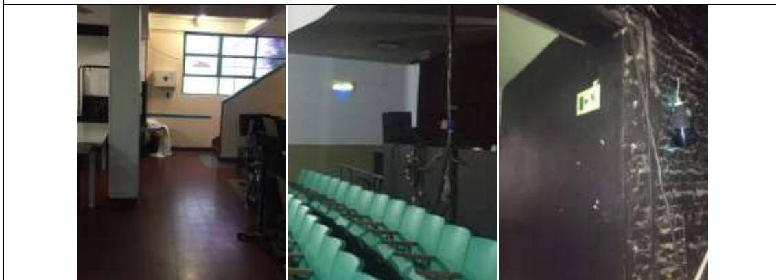
Fotos 15-16-17 Bandeja de luz y sonido en sala con instalación eléctrica expuesta
