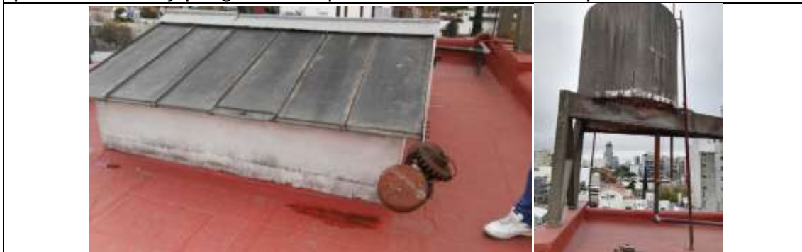
Fotos 15-16 Claraboya cenital de evacuación de humo, contrapesos de claraboya insuficientes. Tanque de reserva de incendio
