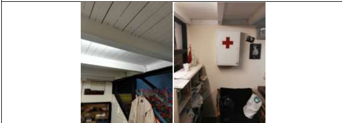
Fotos 12-13 Se observa un gran porcentaje de madera en la estructura de entrepisos, piso del salón para la superficie cubierta con el consecuente riesgo respecto al cumplimiento de las condiciones de seguridad contra incendio.
