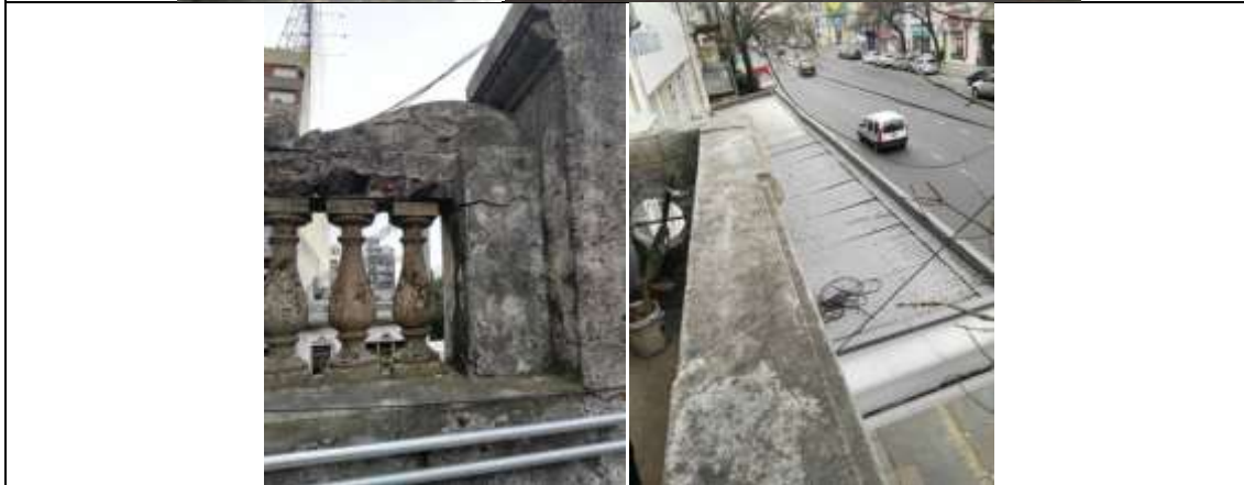
Fotos 11-12-13-14 Molduras, balaustres y revoques de fachada con armaduras expuestas, en pésimo estado y peligro de desprendimiento hacia la vía pública
