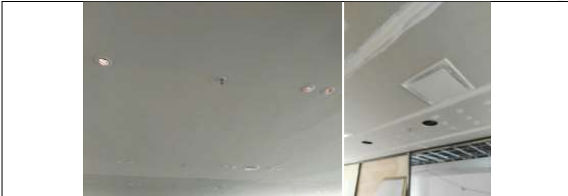
Fotos 14-15 Sistema de sprinklers contra incendio. El sistema de luz de emergencia está incorporado a los artefactos lumínicos regulares.
