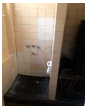
Baños comunes en regular estado
