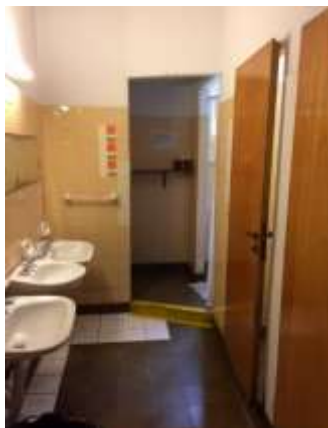
Baños comunes en regular estado
