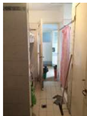
Baño de internación en regulares condiciones
