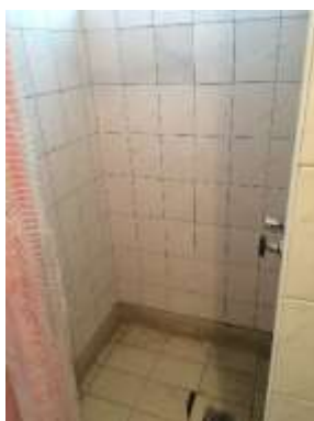
Baño de internación en regulares condiciones
