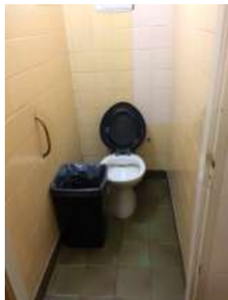
Baños comunes en regular estado
