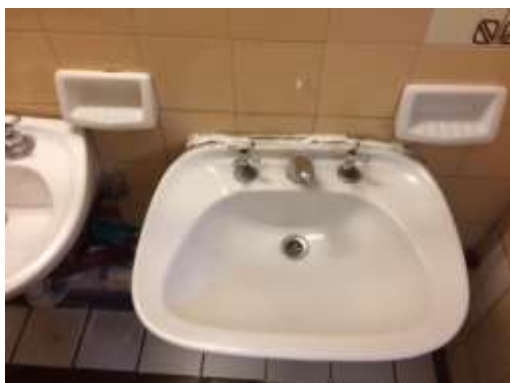
Baños comunes en regular estado
