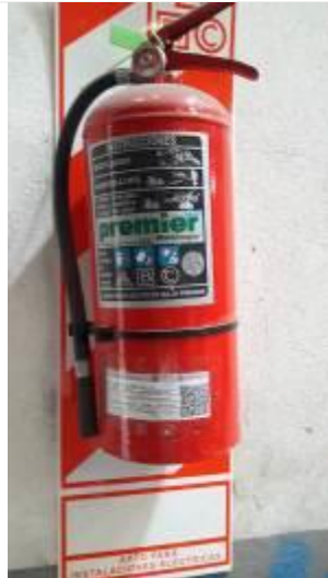
Foto N° 31 Extintores para incendio
