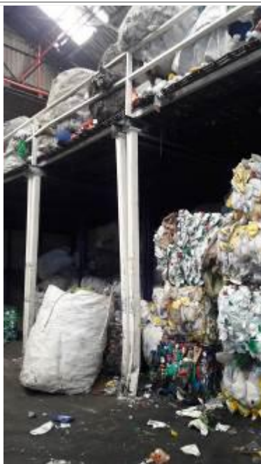
Foto N° 47 Detalle de la columna golpeada.
