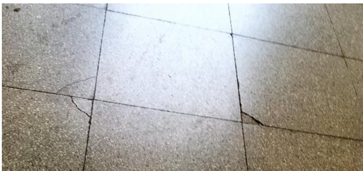
Solado de mosaico granítico mal asentado
