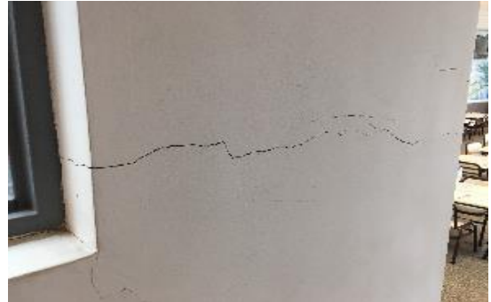
Existen importantes rajaduras (ejemplo: cocina)
