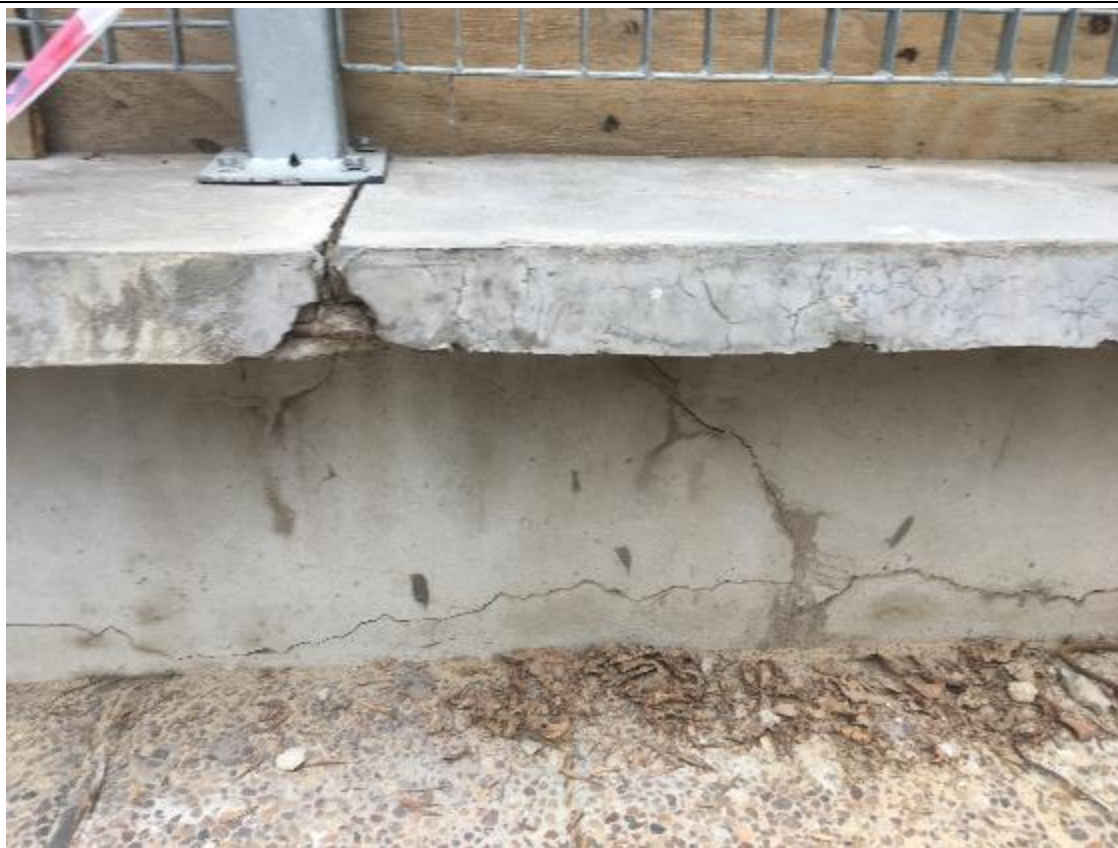
Base rajada y con deficiencias en la terminación que constituye los bancos en el acceso
