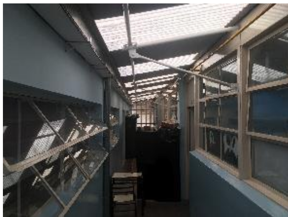
Aulas sin ventilación
