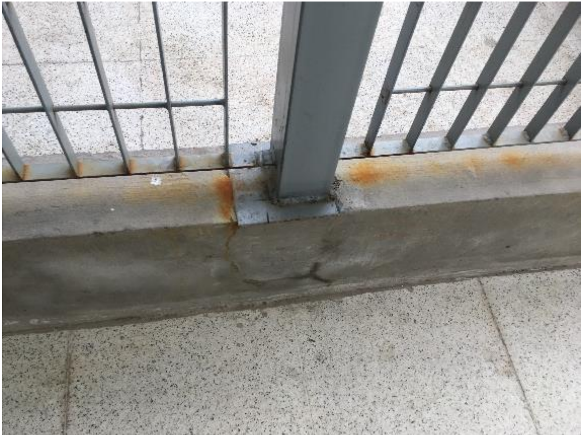
Deficiencias en la pintura y en el anclaje de rejas perimetrales.
