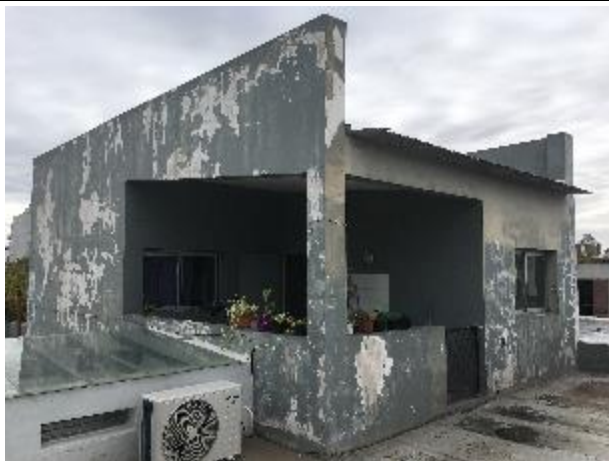
La pintura aplicada presenta fallas evidentes
