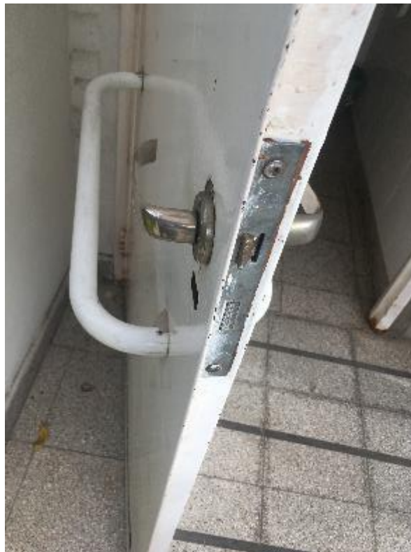
La cerradura del sanitario diferencial no cumple norma
