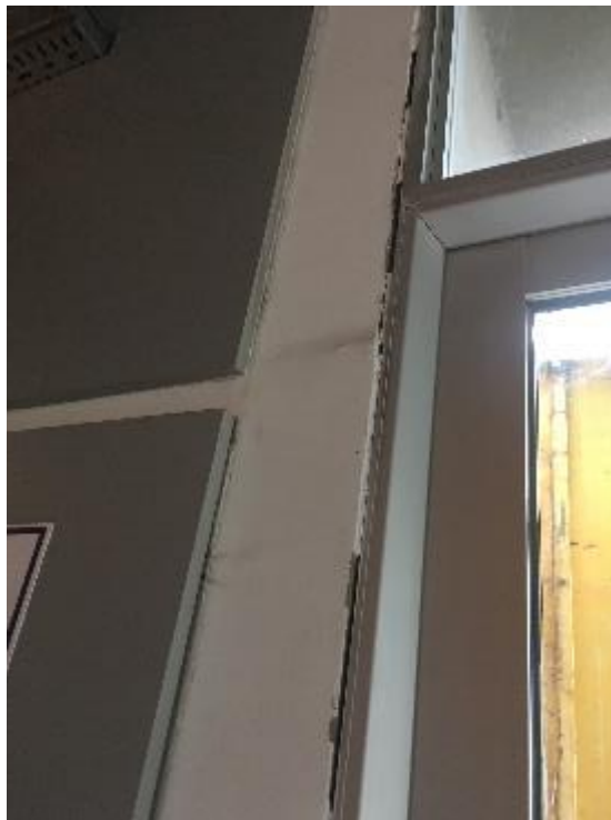
Fallas en la unión de aberturas con los muros
