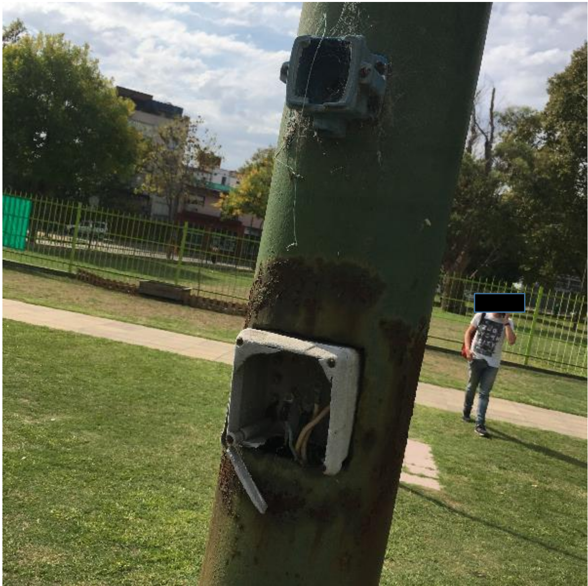
Columna de iluminación exterior con sistema eléctrico en exposición.
