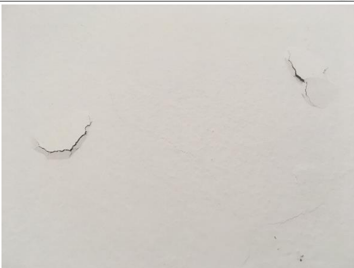
Defectos del revoque que aparecen en muros interiores (posible vicio oculto de la obra original)
