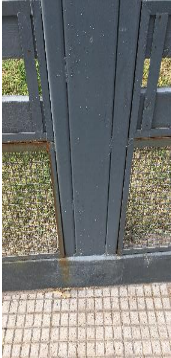
Deficiencias en la pintura en el armado de la reja
