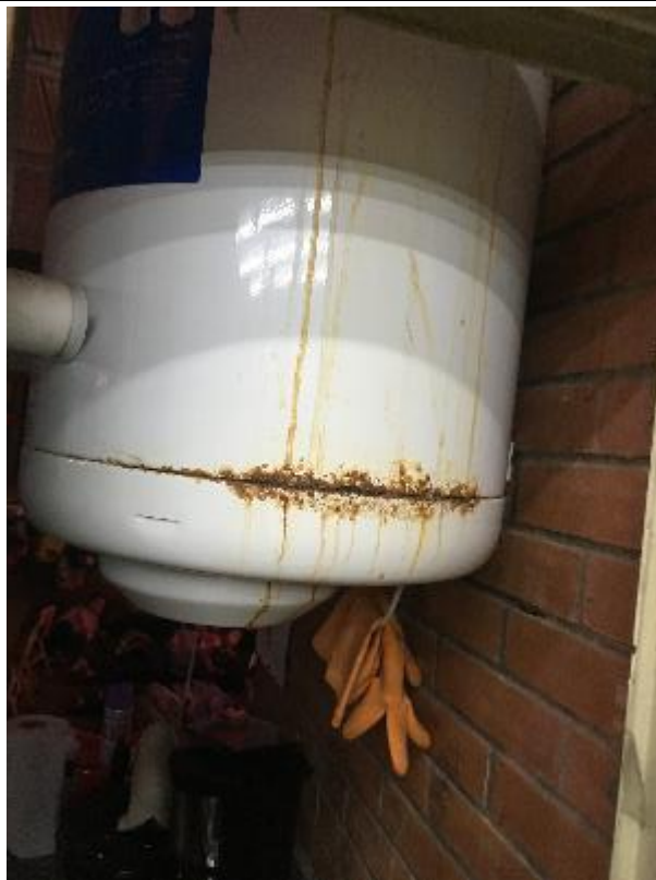
Termotanque afectado por la oxidación
