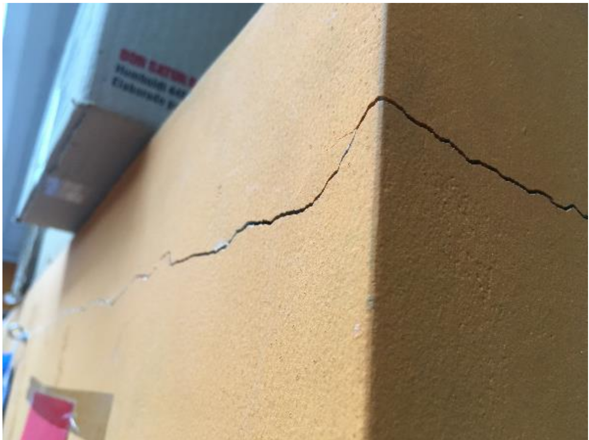
Se verifican rajaduras en varias partes del edificio. Este caso ilustra encuentro de losa en los armarios
