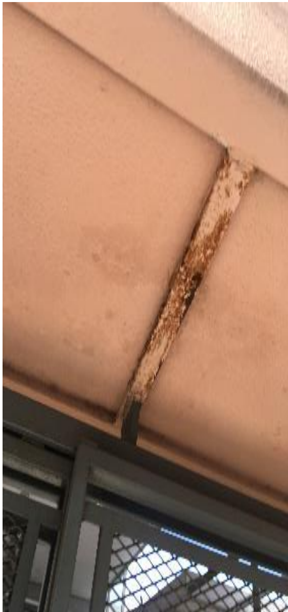
Estructura de la marquesina, oxidada
