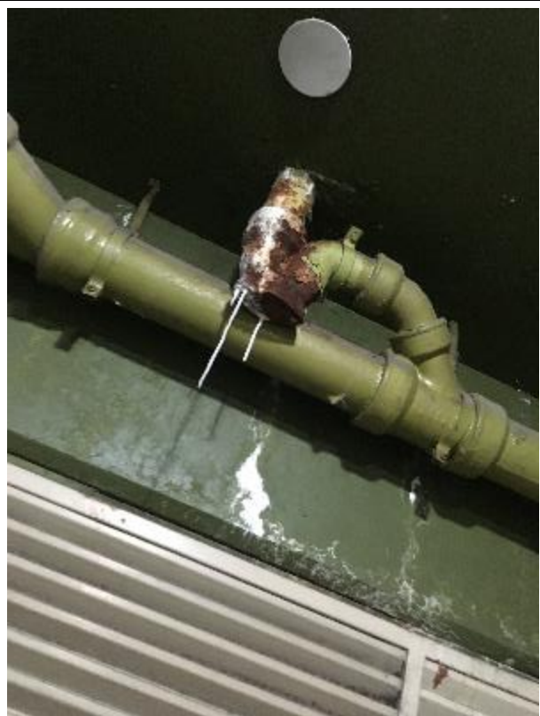
Cañerías obstruidas. Ausencia total de mantenimiento
