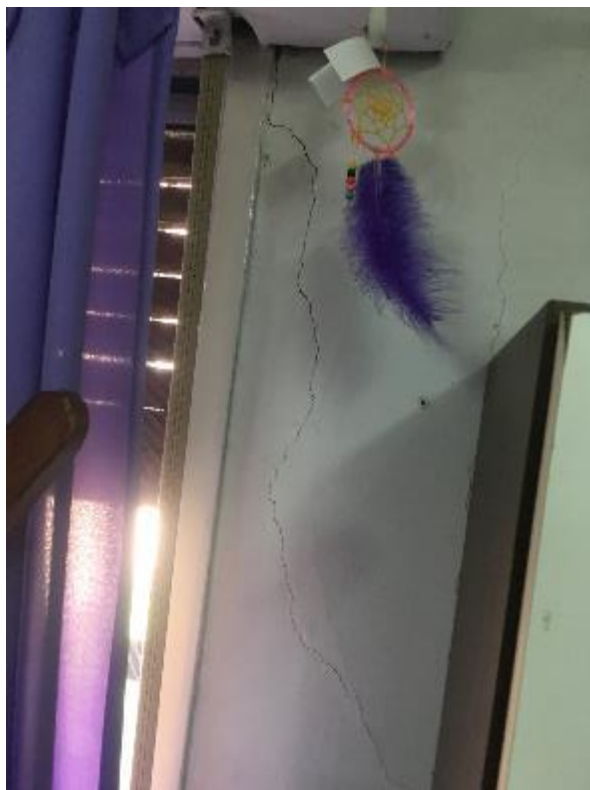
Se verifica rajadura vertical en muro de la Dirección
