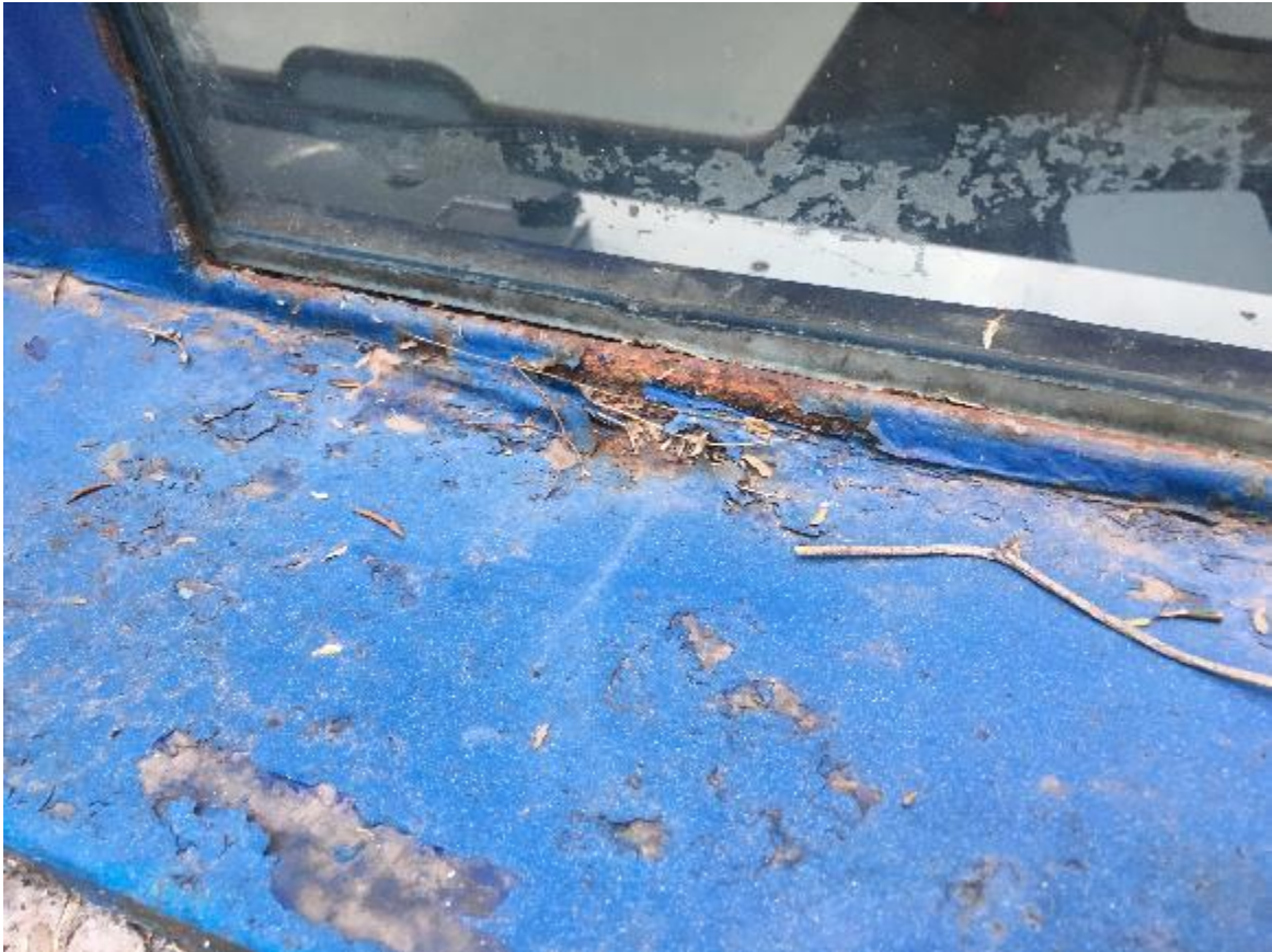
Oxidación de marcos de aberturas por falta de mantenimiento
