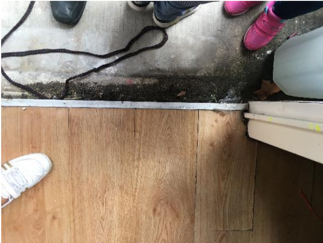
Afectación del piso y fallas de resolución de solía exterior
