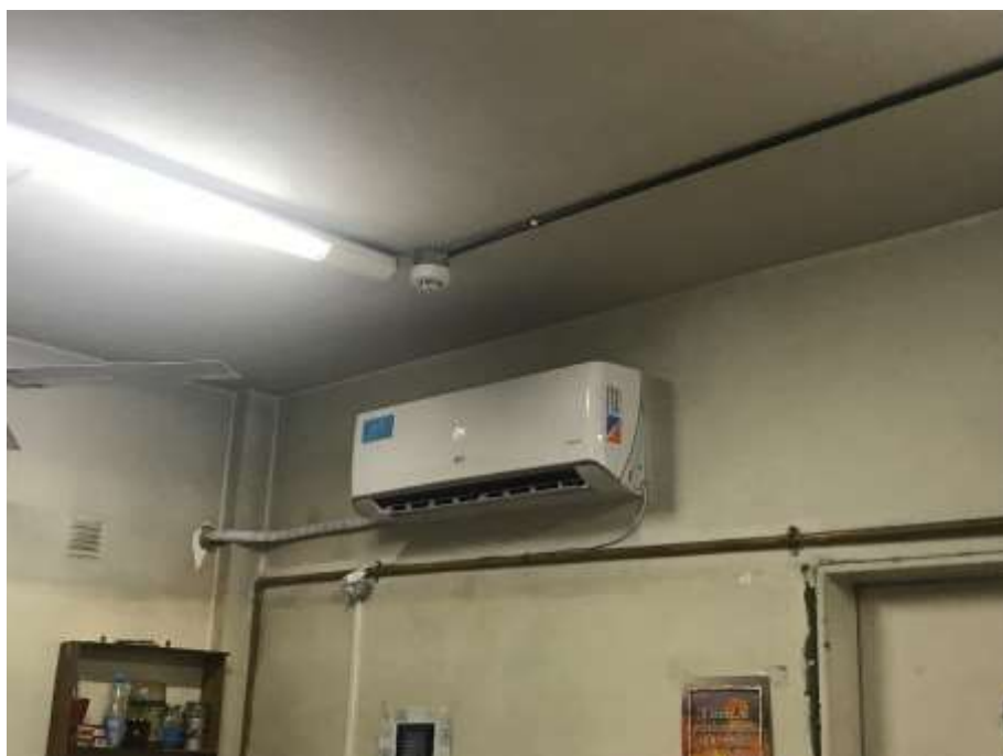
Foto N°11: Cesac N°3 : Se encontraron en todos los Cesac, aires acondicionados en funcionamiento.
