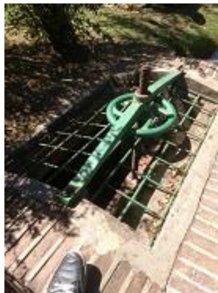
Vista de la compuerta de evacuación y compuerta de evacuación.
