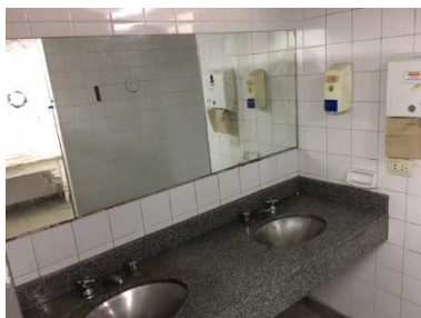
Baños en regular estado
