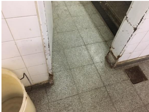
Marcos en mal estado
