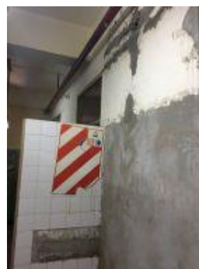
Vestuarios en malas condiciones
