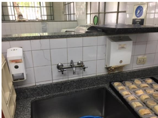
Azulejos y granitos rotos
