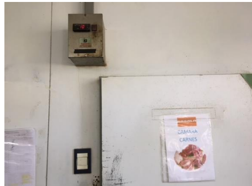
Buen Control de temperatura en camaras
