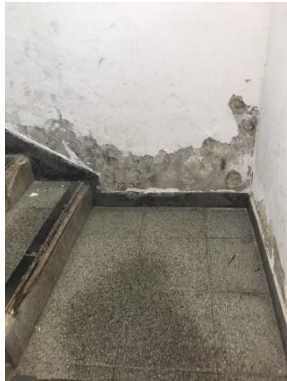
Acceso a vestuario con humedades
