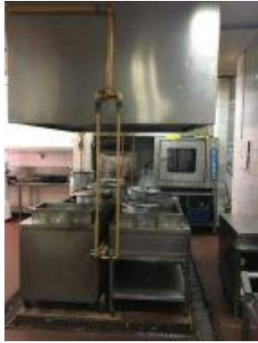
Instalaciones de gas accesible
