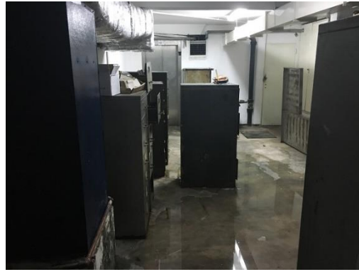
Rebalse de agua contaminada
