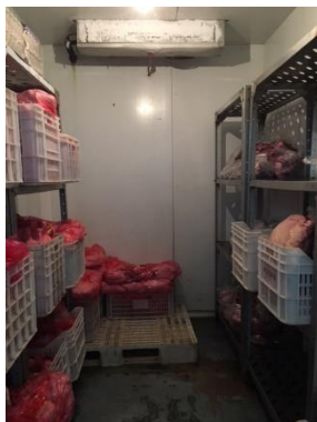
Interior de cámara frigorífica
