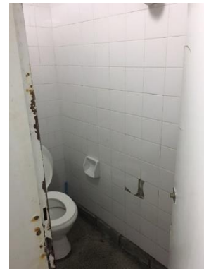
Baños en regular estado
