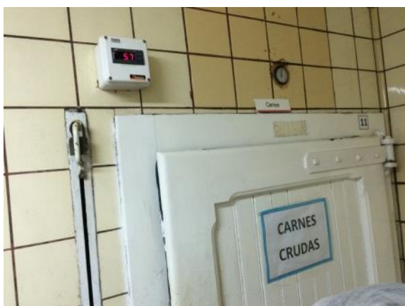
Control de temperatura en cámara de carnes
