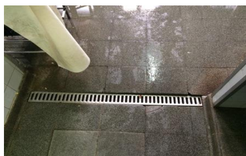
Rejillas en piso de inoxidable
