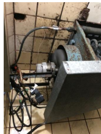
Falta de limpieza en equipo de refrigeración
