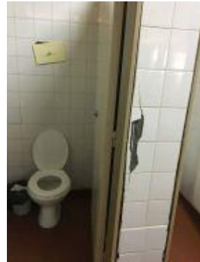
Vestuarios en malas condiciones
