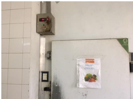
Buen Control de temperatura en camaras
