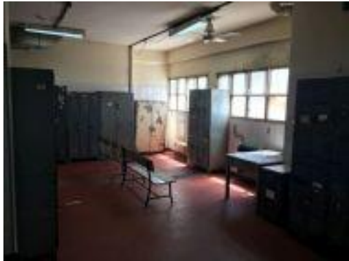
Vestuarios en malas condiciones
