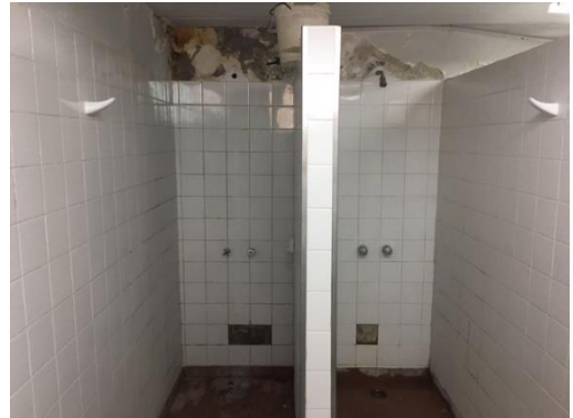
Baños en regular estado
