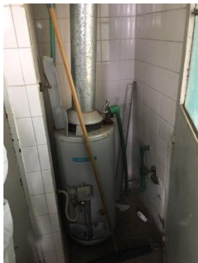
Termotanque de alta recuperacion
