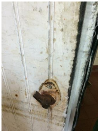
Falta manija acceso a camara
