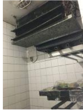
Equipo enfriamiento cámara
