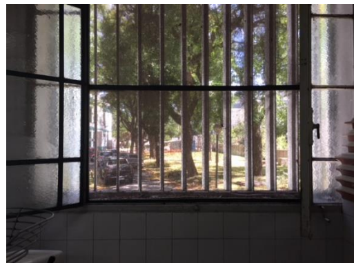
Mosquiteros en regulares condiciones
