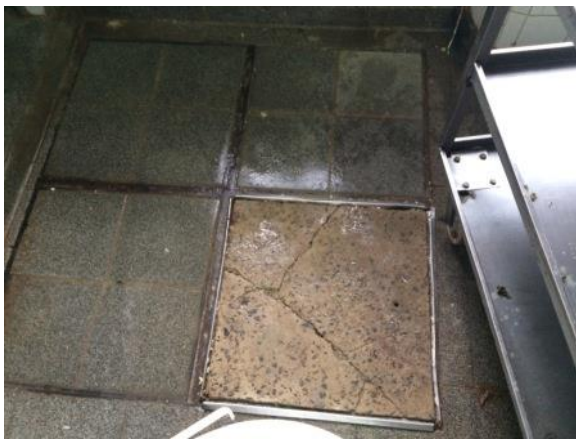
Piso con cerámicas faltantes
