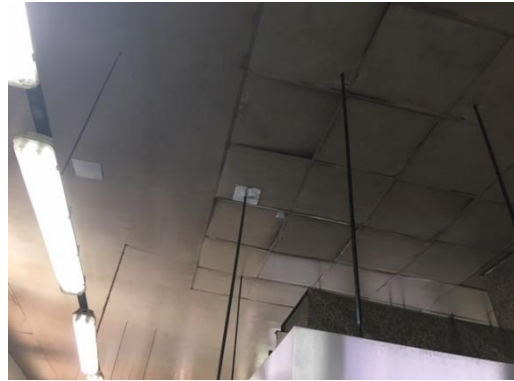
Cielorrasos en mal estado
