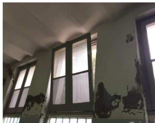
Humedades en paredes
