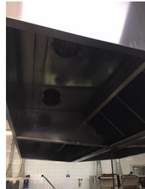
Campanas sin elementos de extincion
