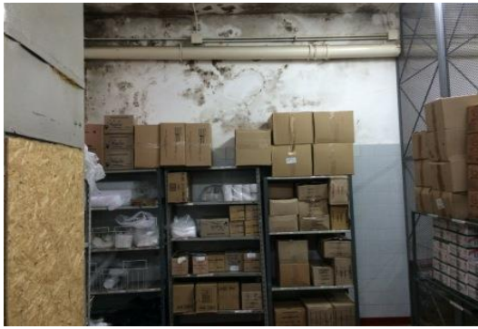
Humedades en área depósito
