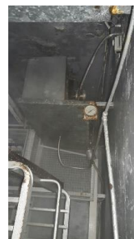
Reloj de control térmico
