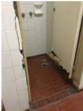
Vestuarios en malas condiciones
