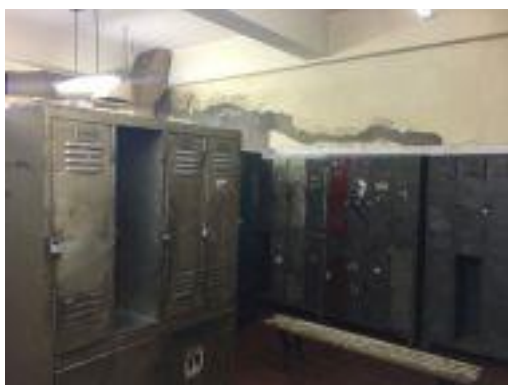
Vestuarios en malas condiciones
