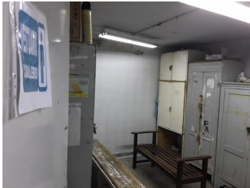
Vestuarios en regular estado
