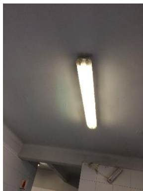
Iluminación sin protección de seguridad
