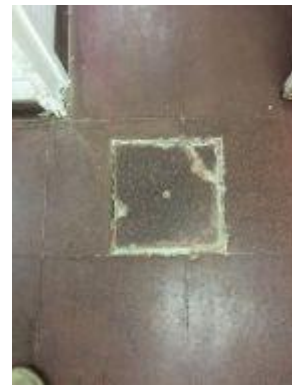
Pisos en regulares condiciones
