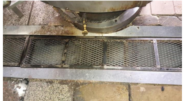
Rejilla perimetral sector ollas
