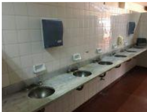
Vestuarios en malas condiciones
