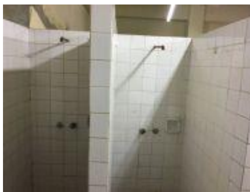
Vestuarios en malas condiciones
