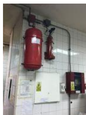
Control de incendio de campana
