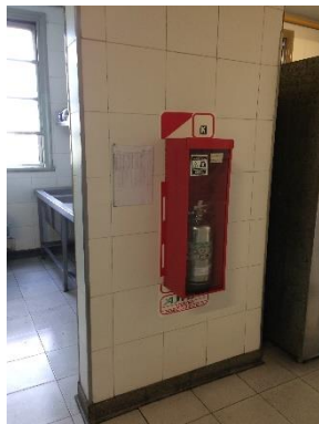
Correcto estado de matafuegos
