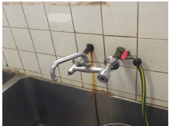
Griferías en mal estado
