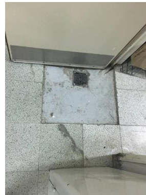
Rejilla para evitar inundación en Zona de depósito y office
