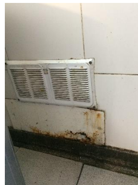
Falta de pintura
