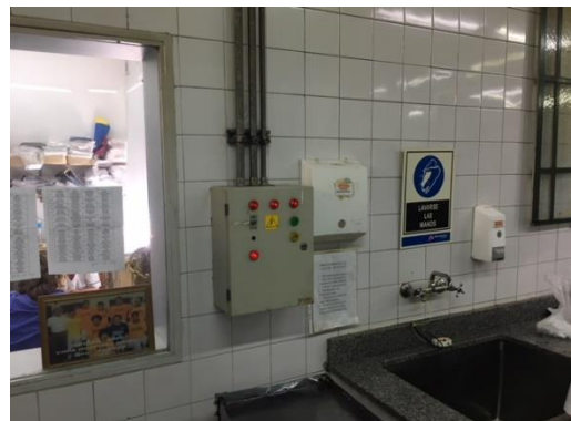
Inst. electrica en buenas condiciones
