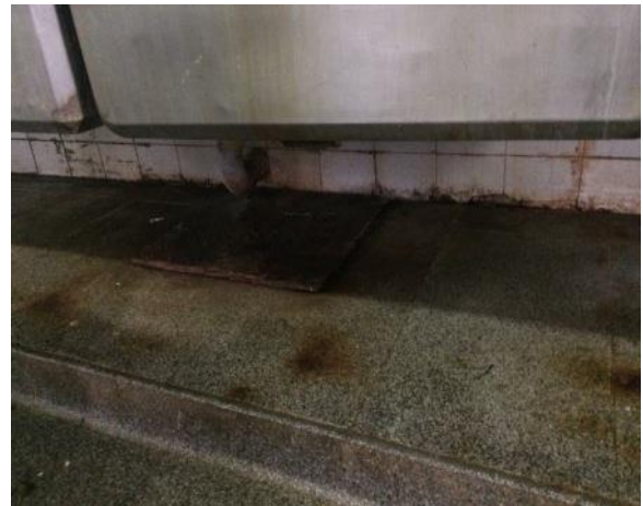
Banquinas en mal estado
