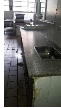
Pileta de lavado azulejos rotos
