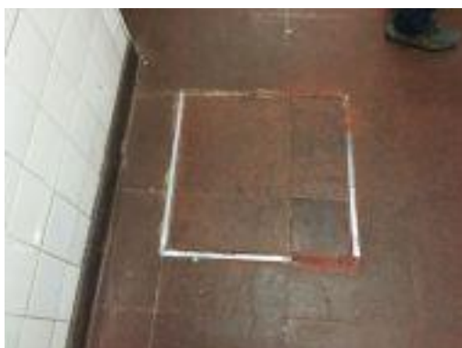
Pisos en regulares condiciones
