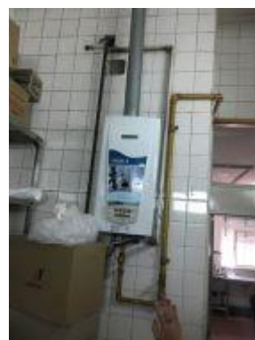
Calefón (poca provisión de agua caliente)
