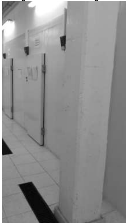
Desagües Cámaras Frigoríficas
