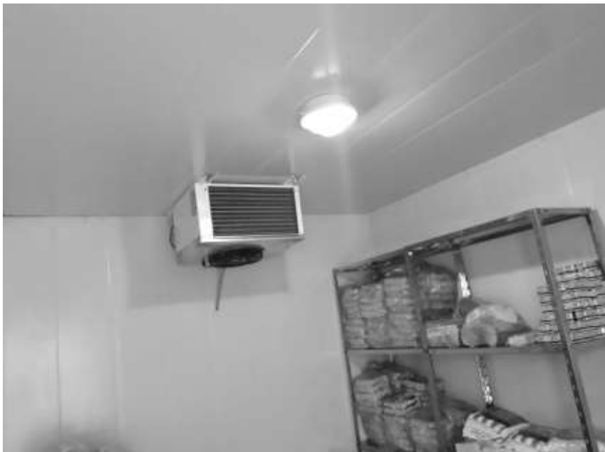
Interior de Cámaras Frigoríficas
