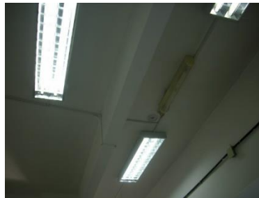
Detectores de humo incompletos (Observación 17.4)
