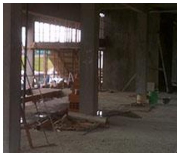
Sector sin limpieza de obra
