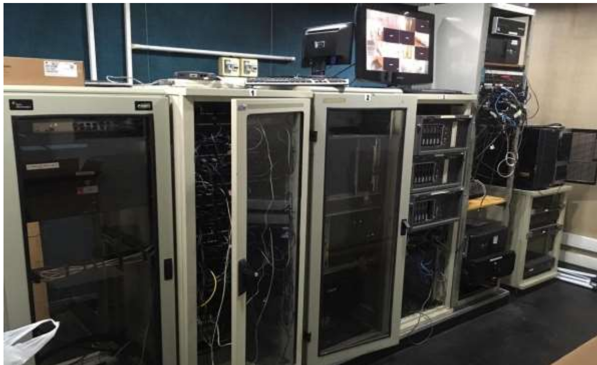
Foto7: Equipamiento de transmisión. Transmisores.
