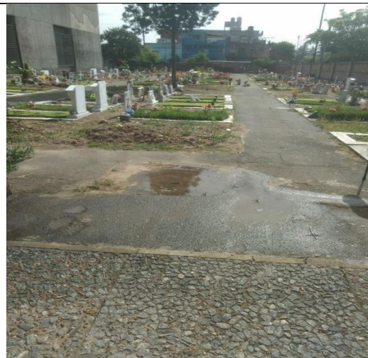
C. Flores. Charco en vereda por rotura y pérdidas de cañerías de agua no reparadas.
