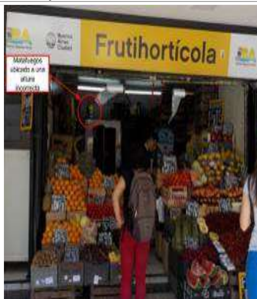
Foto N° 100 - Local 9. Frutihortícola, sobre la calle Rojas. Matafuegos Ubicado a altura incorrecta.
