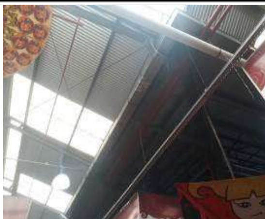
Foto N° 87 - Canaletas con filtración.
