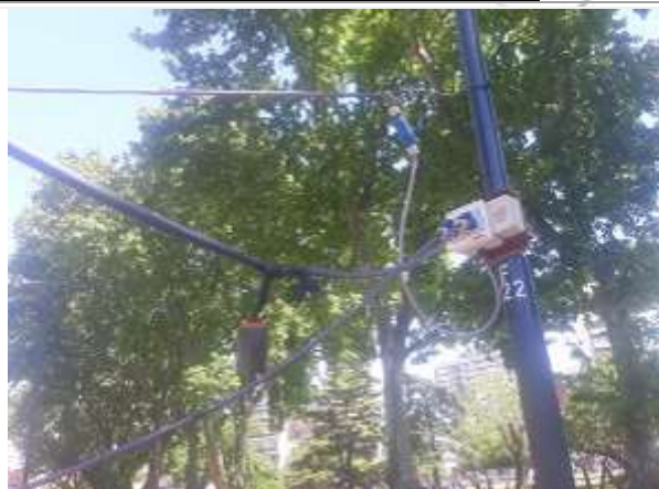
Foto N° 22 - Instalación eléctrica precaria sin puesta a tierra
