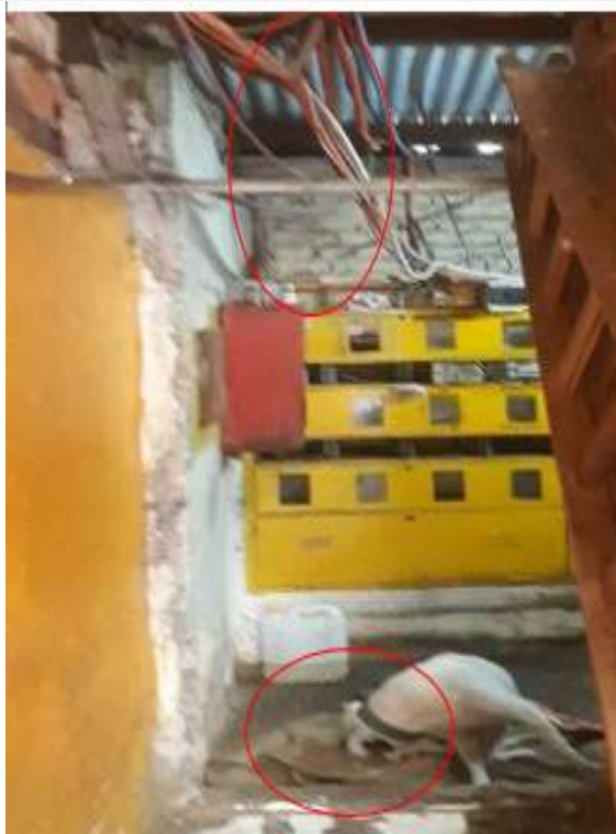
Foto N° 115 - Cables expuestos, techo de chapa - Perro dentro de sala de medidores
