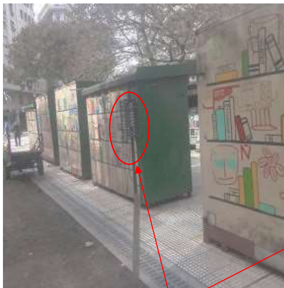
Foto N° 37 Parte trasera de los puestos algunos con medidor de luz sin instalación de puesta a tierra.
