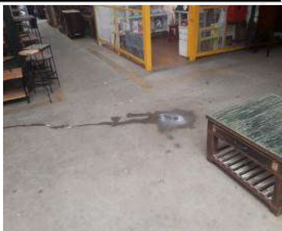
Foto N° 88 - Filtración de cañerías.
