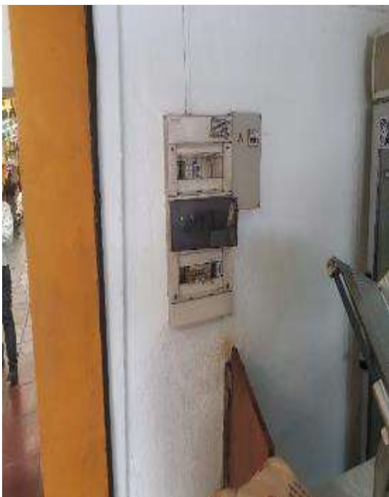
Foto N° 113 - Tablero independiente en cada local.
