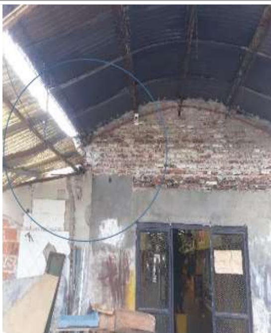
Foto N° 117 - Salida para los permisionarios al garaje y depósito- Falta de mantenimiento.
