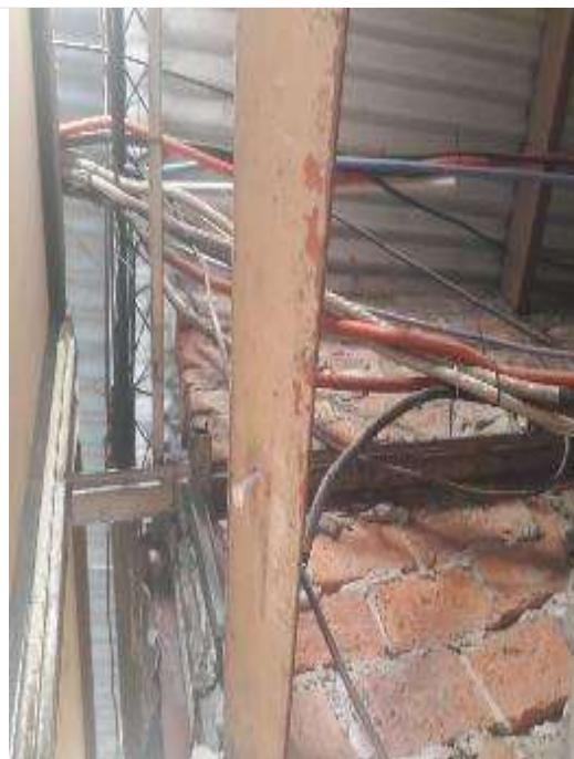
Foto N° 114 - Instalación inadecuada techo de chapa al descubierto sin protección.
