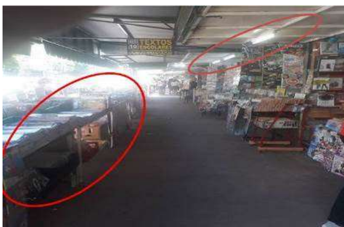
Foto N° 28 - Mesas fuera de lugar asignado- Cables expuestos.
