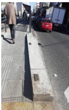
Faltante de baranda en rampa
