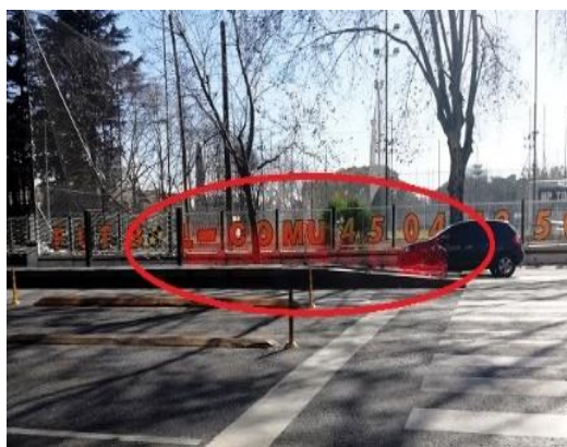
Faltante de baranda y modulo límite metálico
