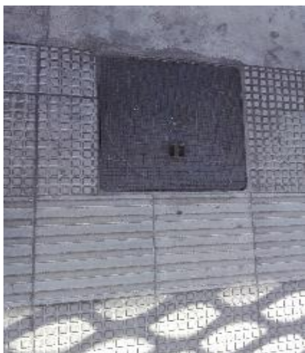
Cámara de electricidad
