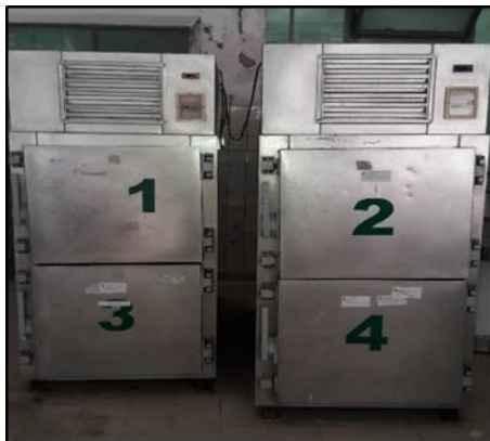
Cámaras en funcionamiento (obs.11)
