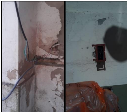
Instalaciones precarias / Control Biométrico mal ubicado (obs.11)
