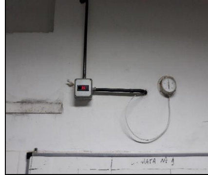
Control digital de la temperatura (obs.11)
