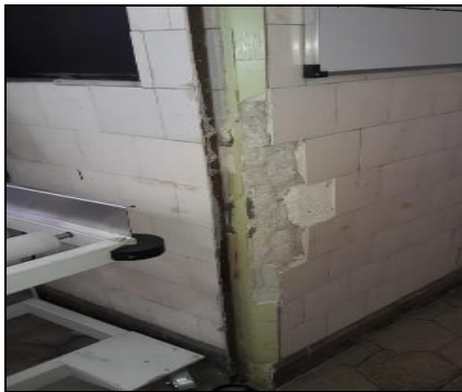
Falta de mantenimiento (obs.11)
