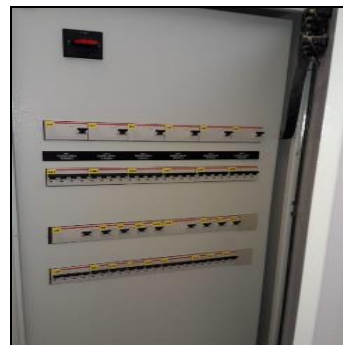
Instalación eléctrica (obs.11)
