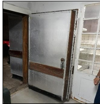
Burletes en mal estado (obs.11)
