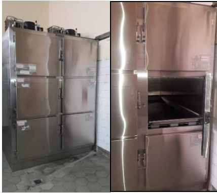
Cámaras nuevas (obs.11)
