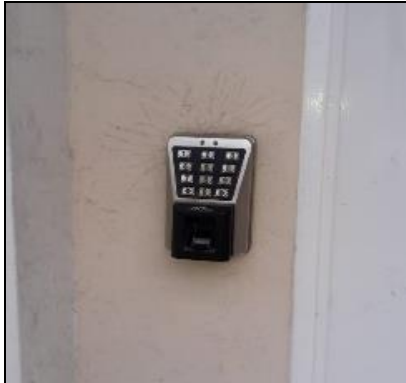
Control Biométrico de acceso a la Morgue (obs.7)
