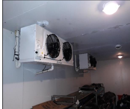
Equipamiento de frio en buenas condiciones(obs.11/33)
