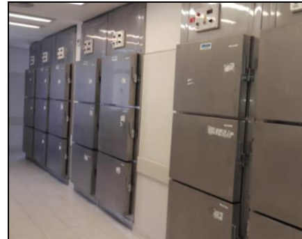
Nuevas cámaras (obs.11)
