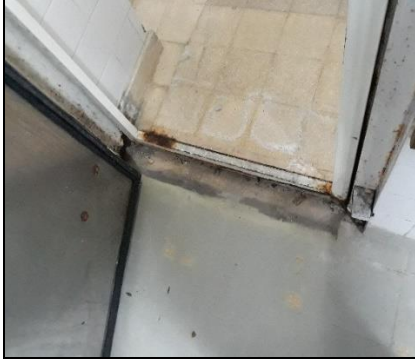
Zócalos en mal estado (obs.11)
