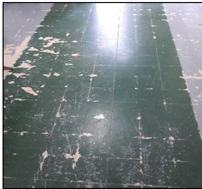
Pintura piso en mal estado (obs.11)
