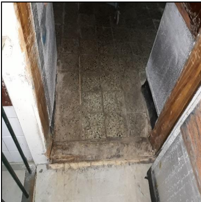
Zócalos y marcos en mal estado (obs.11)
