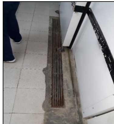
Rejilla de acceso a la cámara en regulares condiciones (obs.11/33)
