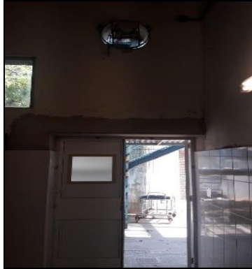
Escasa ventilación (obs.11)
