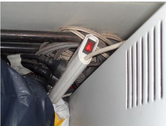
Instalaciones eléctricas sin el adecuado nivel de protección, viejas o sobrecargadas, uso de multiconectores
