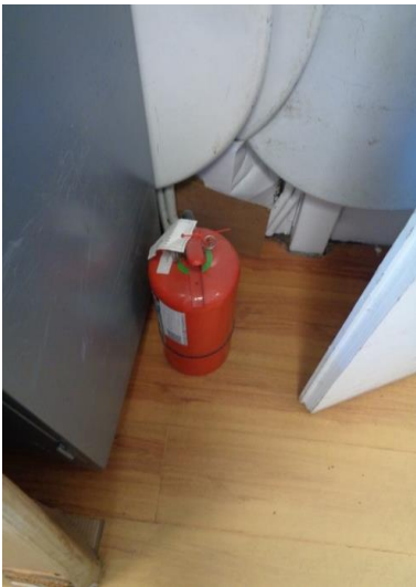
Extintores de incendio colocados fuera del dispositivo correcto
