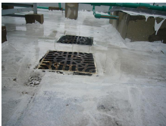
Inadecuada pendiente de desagüe en terraza.
