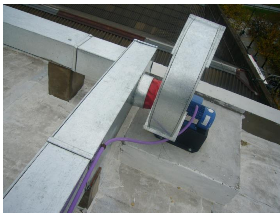
Vista del recirculador en terraza
