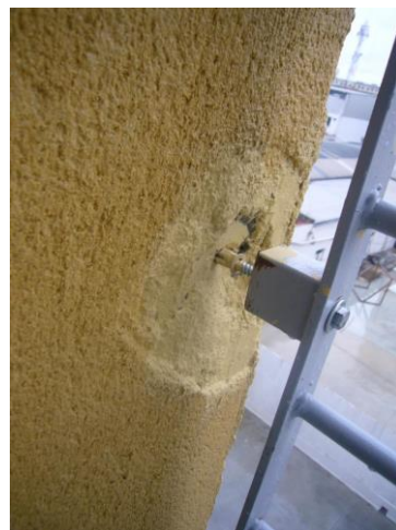
Rejas con fallas en la sujeción
