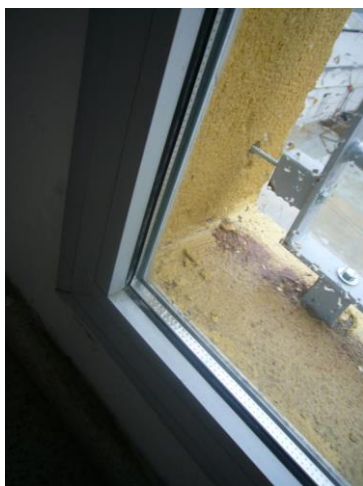
Rejas con fallas en la sujeción
