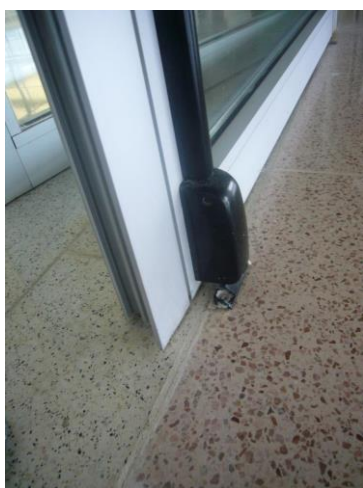
Falta de calibración de herrajes.
