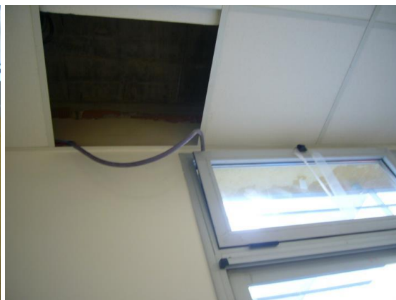
Cable eléctrico provisorio tipo Sintenax en techo.
