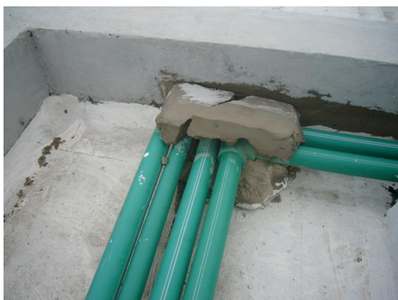
Fijación inadecuada de cañerías externas.
