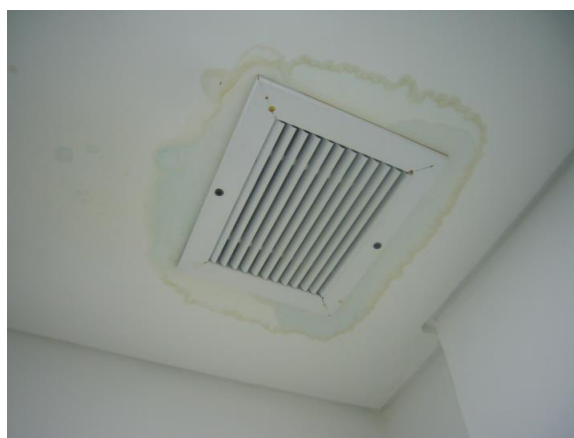
Filtraciones a través el conducto de ventilación.
