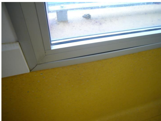
Contramarco mal colocado.
