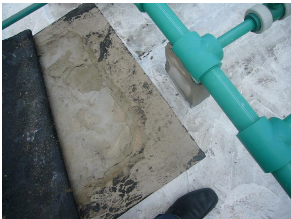
Vista de la membrana despegada sin imprimación.
