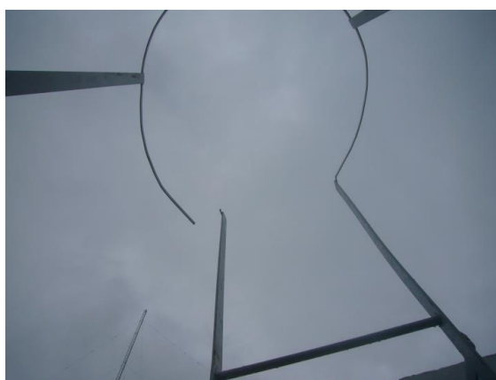
Protección de escalera al techo desoldada.
