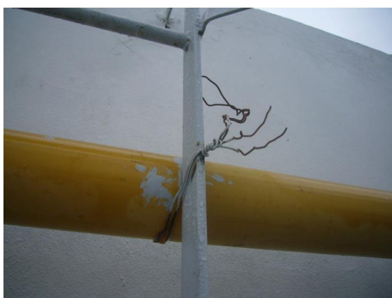
Sujeción no adecuada
