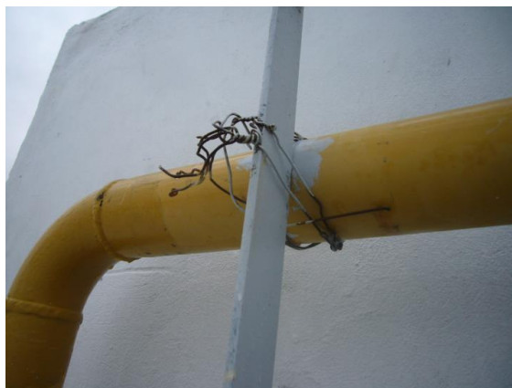
Cañería fijada a la escalera con alambres.
