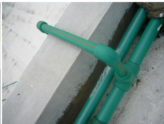
Tramo de cañería sin protección UV
