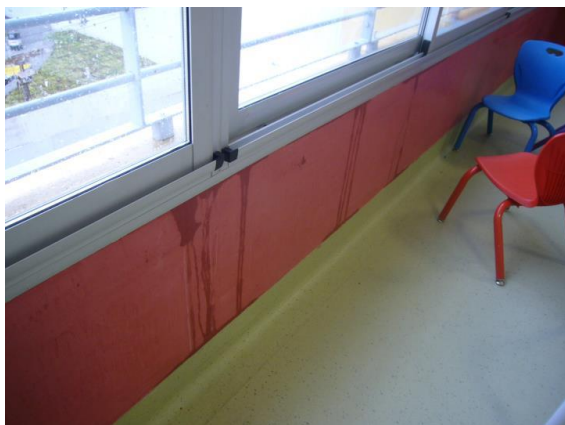
Chorreaduras bajo la carpintería
