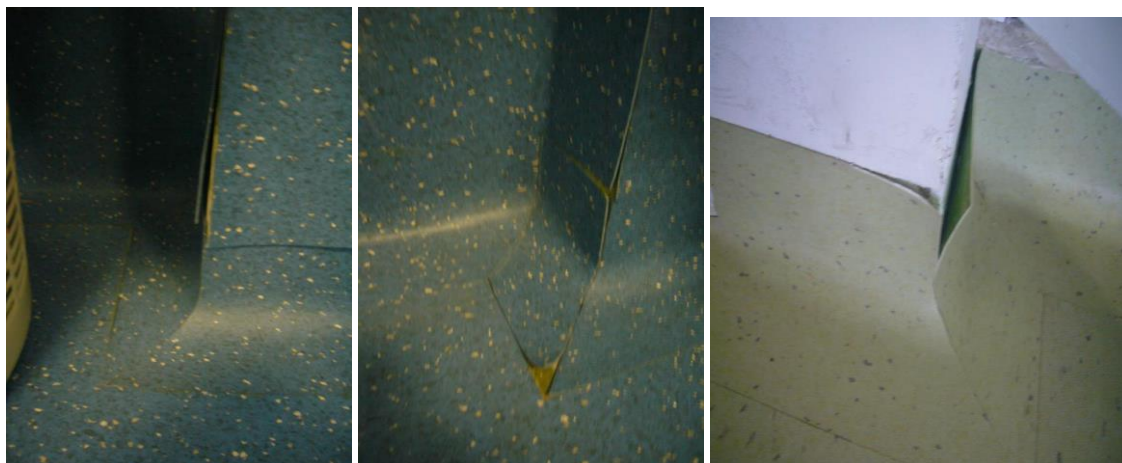
Ejemplos de pisos con incorrecta aplicación por mano de obra inexperta.
