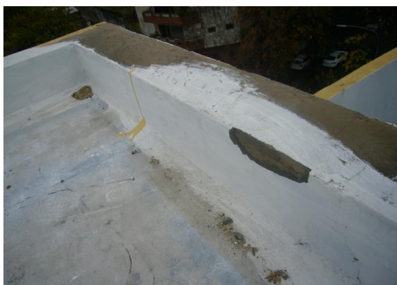
Problemas en revoques, terminación.
