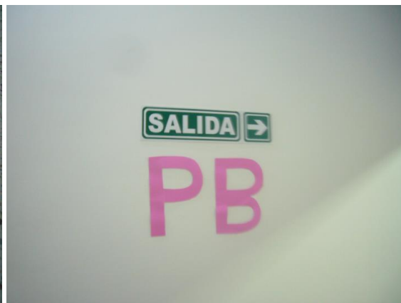
Ausencia de señalética conforme pliego
