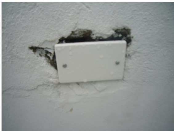
Boca en exteriores sin protección adecuada.
