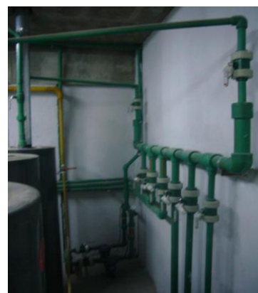
Falta conexión eléctrica de bombas.
