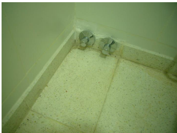
Llaves de paso ubicadas en el zocalo.
