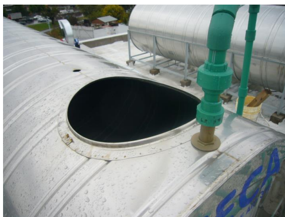
Faltan tapas en tanques de agua.
