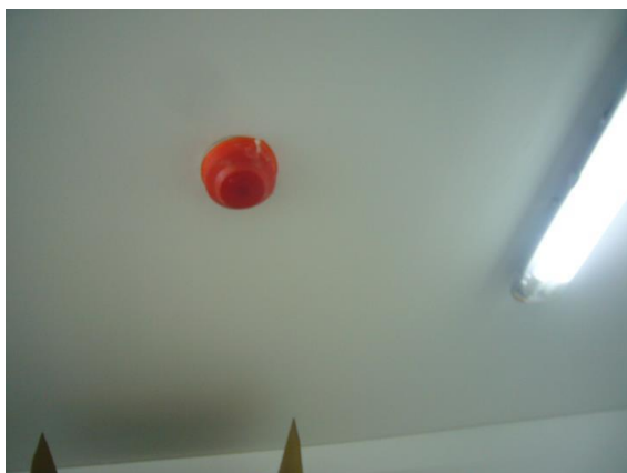
Sensor de humos sistema contra incendio
