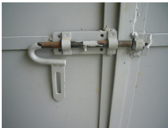
Herraje con mala calidad de terminación.
