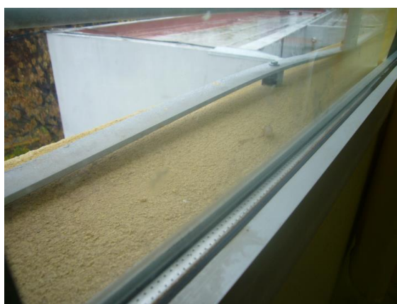
Rejas mal ejecutadas.
