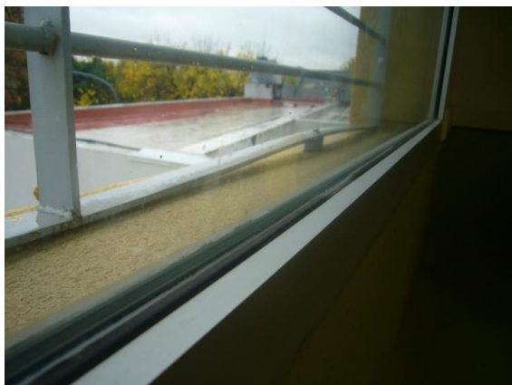
Reja en ventana deformada
