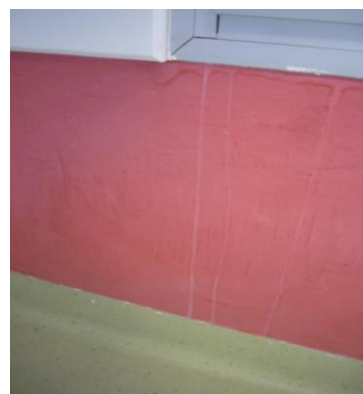
Se verifican filtraciones en las carpinterías
