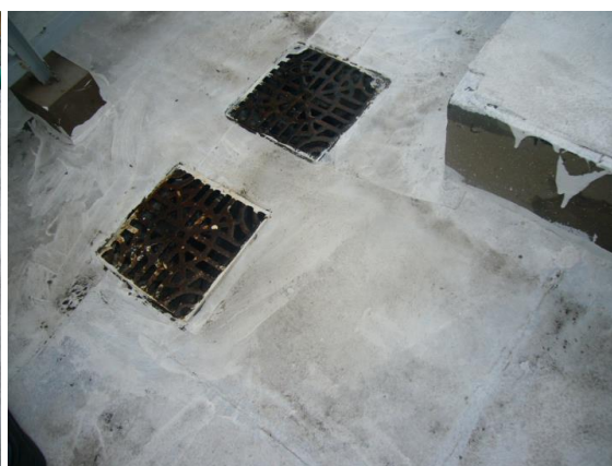
Inadecuada pendiente de desagüe en terraza.
