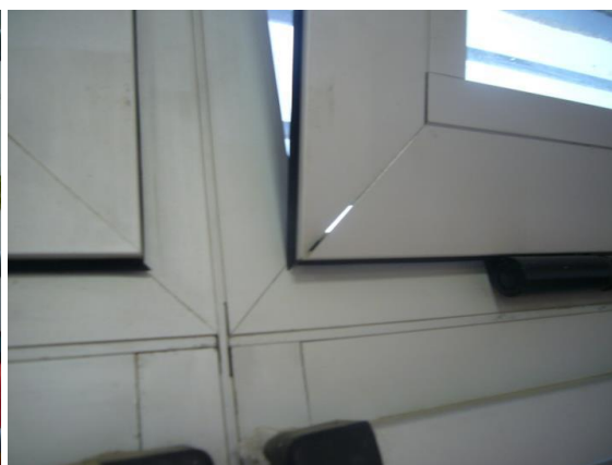
Mal armado de escuadría.
