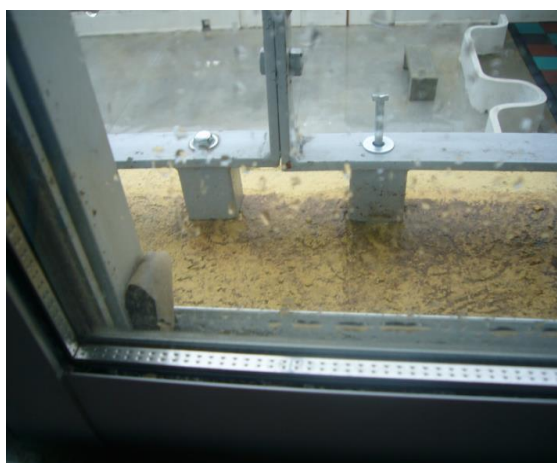
Presencia de riesgo por incorrecta fijación
