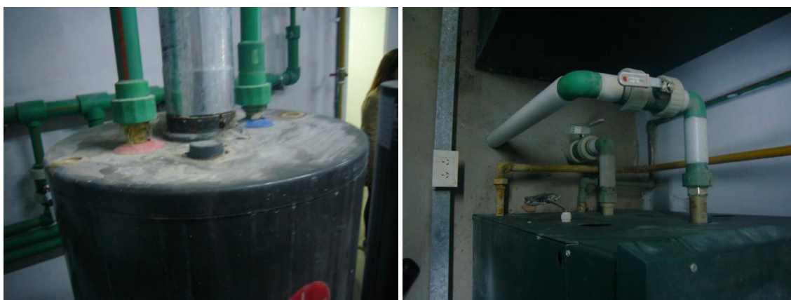
Vista de sala de máquinas
