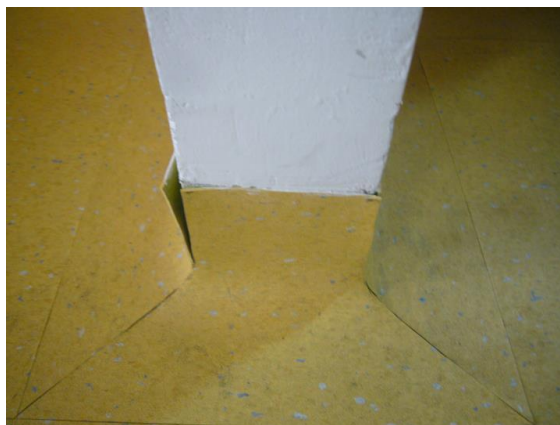
Falta de sellado en las uniones y el pegado en aulas
