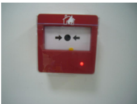
Terminal de accionamiento alarma de incendio
