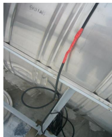
Conexión fuera de norma en tanque de reserva
