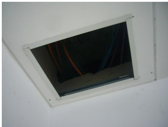
Falta de tapa de acceso en cielorraso
