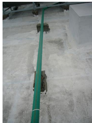
Tramos de cañerías sin protección UV.
