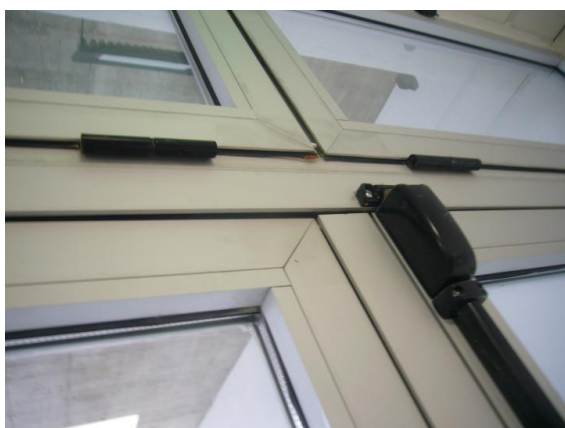
Cierre afectado por falta de plomo
