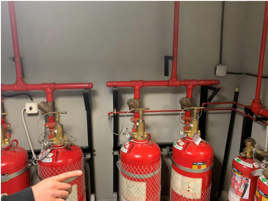
Extinguidores de Incendio de FM200
