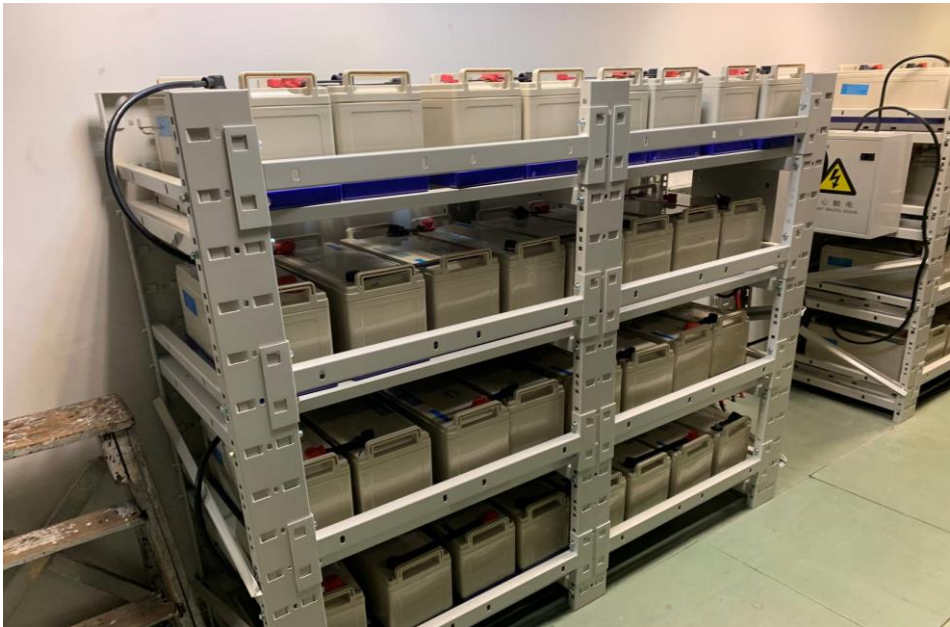
Pack de Baterías de UPS
