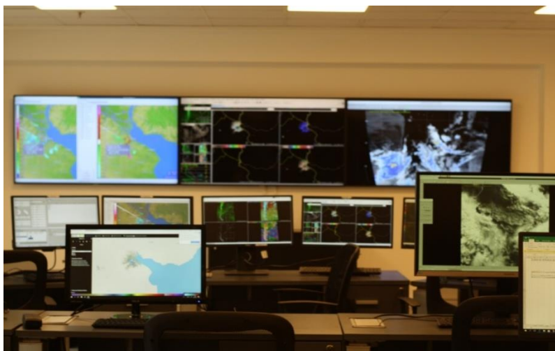
Fuente: Equipo AGCBA; Estación Central de la Red - ECR Sede del Centro Único de Coordinación y Control (CUCC) - Jorge Newbery 4218 esquina Guzmán – CABA, visita realizada por el equipo auditor el 29/07/2019.
