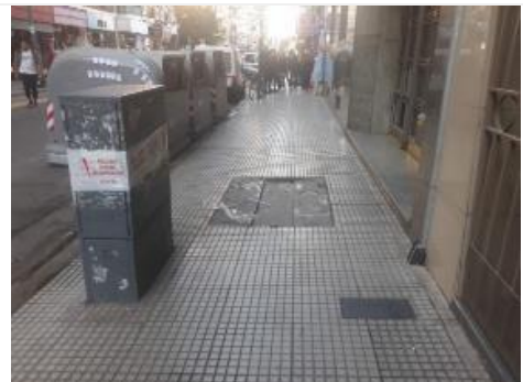
Foto N°4– PLAN ONCE Etapa 4 Castelli 182 Vereda desnivelada con tapas (peligro de tropiezo). Los contenedores de basura están muy cerca del cordón
