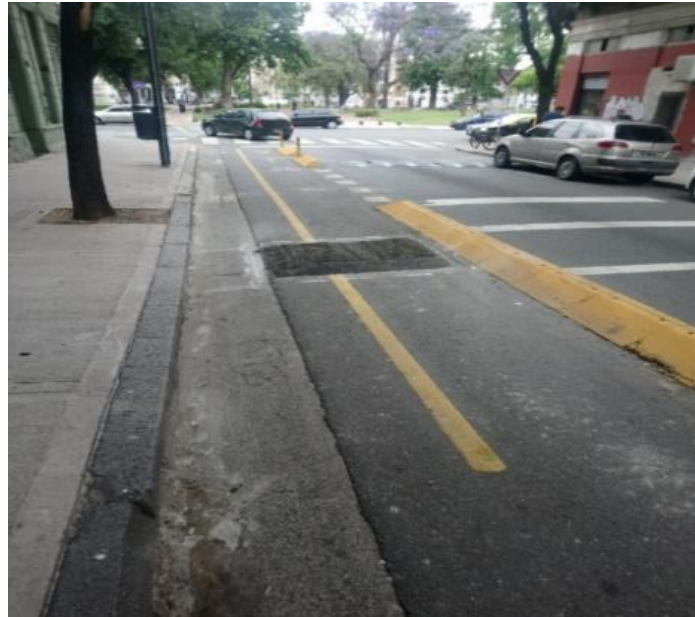
Parche en la ciclovía, produciendo rugosidad e impacto al ciclista, también se observa la diferencia del encuentro del asfalto y el cemento de la cuneta en medio de uno de los carriles. Virrey Cevallos 1487.
