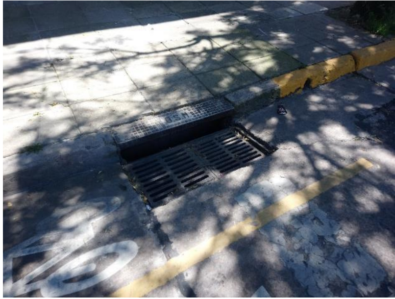
Sumidero sobre carril de ciclovía con amplio desnivel. Juan Agustín García 3213.
