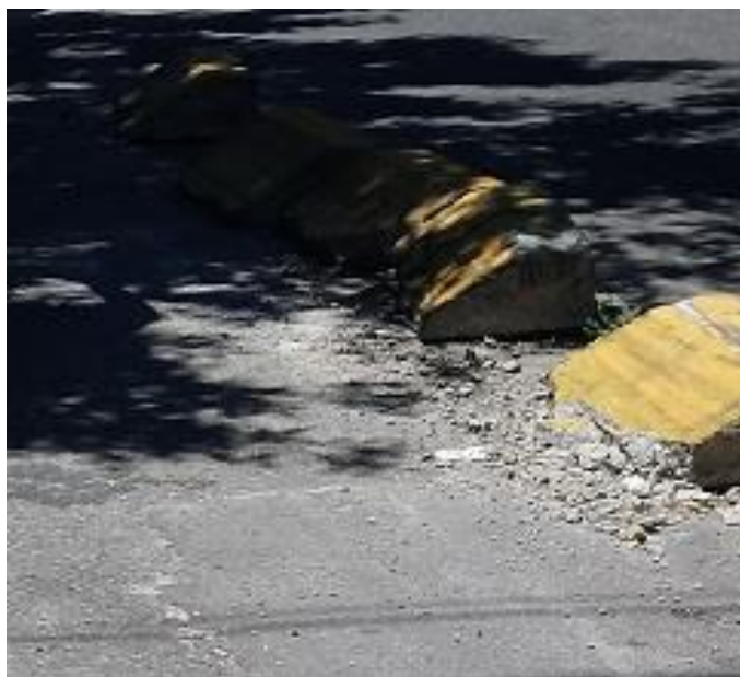
Falta de mantenimiento. Estados Unidos 3650.
