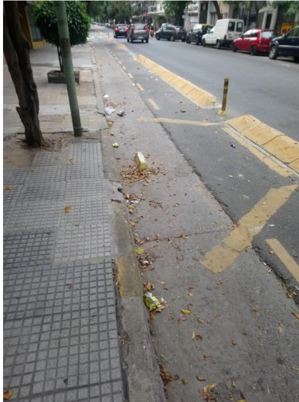
Figura 10. Se observa la construcción de una ciclovía sin el retiro de elementos preexistentes, el mismo representa un alto riesgo a la seguridad por parte de los ciclistas. Ciclovía calle Artigas 1758.
