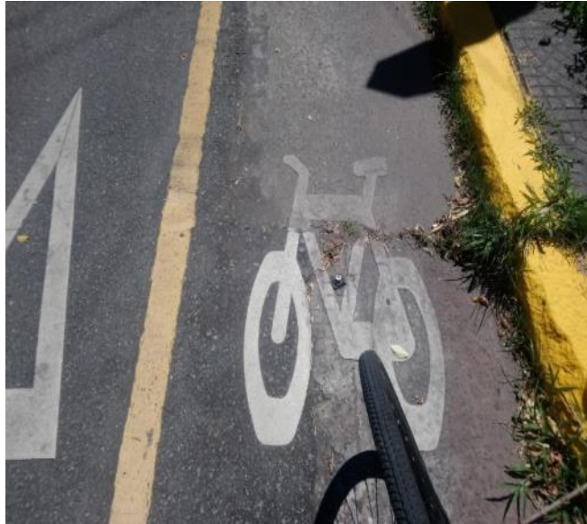
Antiguo anclaje no removido. Elpidio González 5698
