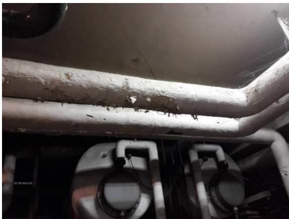
Caldera y caños de agua caliente; presencia de asbestos
