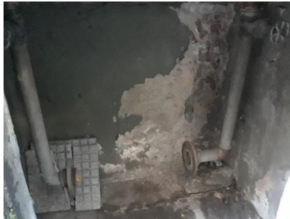
Gabinete de donde se removió el medidor y exclusas que si se abren permiten la salida de gas
