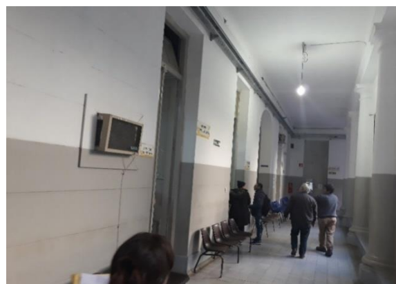
Aires acondicionados que ventilan a un espacio cerrado sin ventilación
