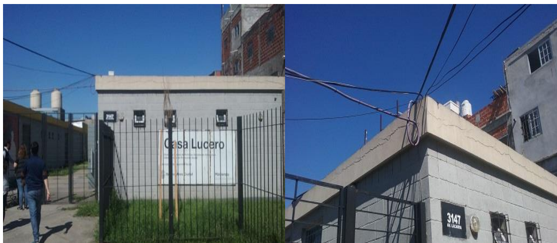
Cables eléctricos sin canalización y rajaduras:
