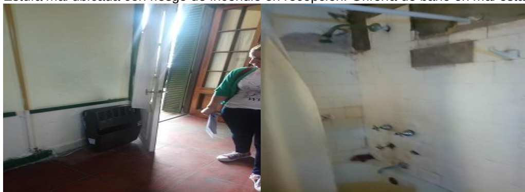
Instalación eléctrica del baño deficiente y sin luz:
