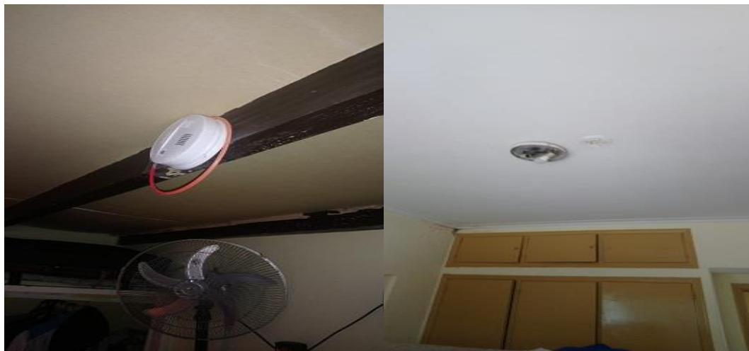
Ducha con grifería incompleta y roseta. Ausencia de extintor de incendios:
