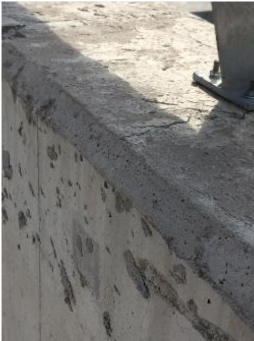
Foto/s N° 7: Muro baranda de la trinchera y Lateral de la Ciclovía mano a Retiro. Se observan fisuras y roturas.
