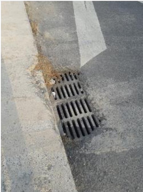
Foto/s N° 5: Boca de desagüe ubicada en Calle Victoria Ocampo y vías del ferrocarril. Se observa la misma fuera de nivel y embutida en el pavimento y el cordón de hormigón roto.
