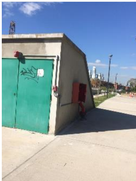
Foto/s N° 11: Calle Trinidad Guevara aprox. Se observa nicho hidrante abierto y sin traba de seguridad.
