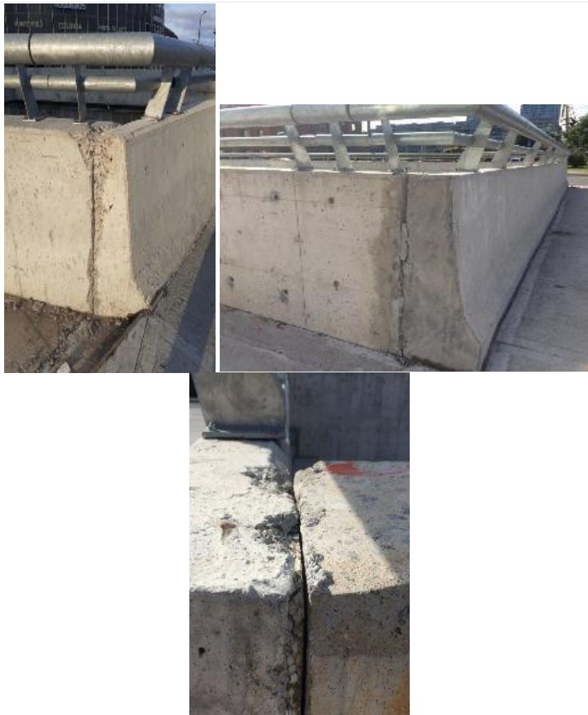
Foto/s Nº 6: Muro baranda de trinchera ubicados frente de Edificio Buquebus, frente a la Dirección General de Migraciones y Calle Regina Pacini de Alvear. Se observa mala terminación de la unión con roturas en la unión de las piezas. Esto ocurre en aproximadamente el 60% de las uniones de los bloques.
