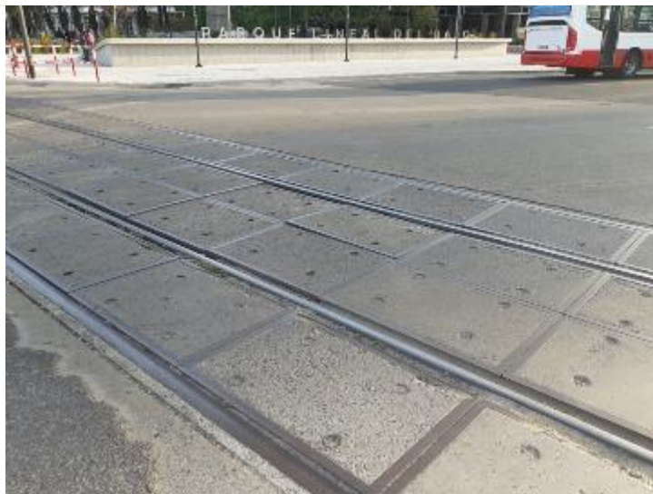
Foto/s N° 4: Cruce Ferroviario Av. Córdoba. Se observan Placas de hormigón sueltas y en desnivel.
