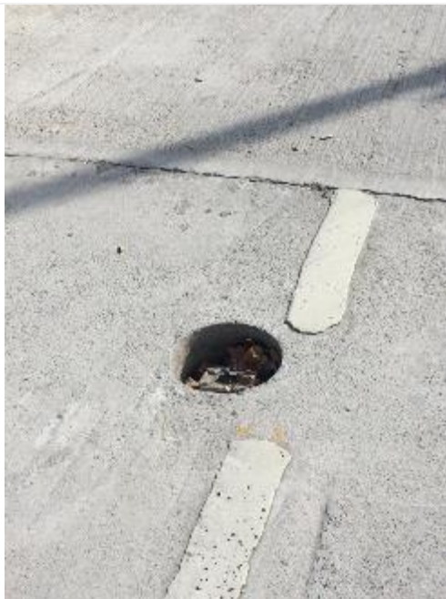
Foto/s N° 8: Ciclovía mano a Retiro. Se observa falta de terminación de detalles
