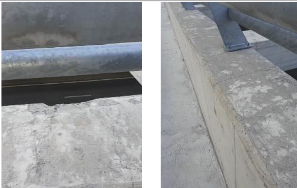
Foto/s N° 3: Muro baranda entre la trinchera y la Ciclovía mano a Retiro – Altura Prefectura Naval Argentina aprox. Se observa hormigón con fisuras y canto roto.
