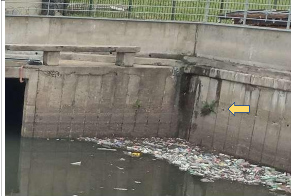
Crecimiento vegetal en junta o grieta en pared del Cuenco
