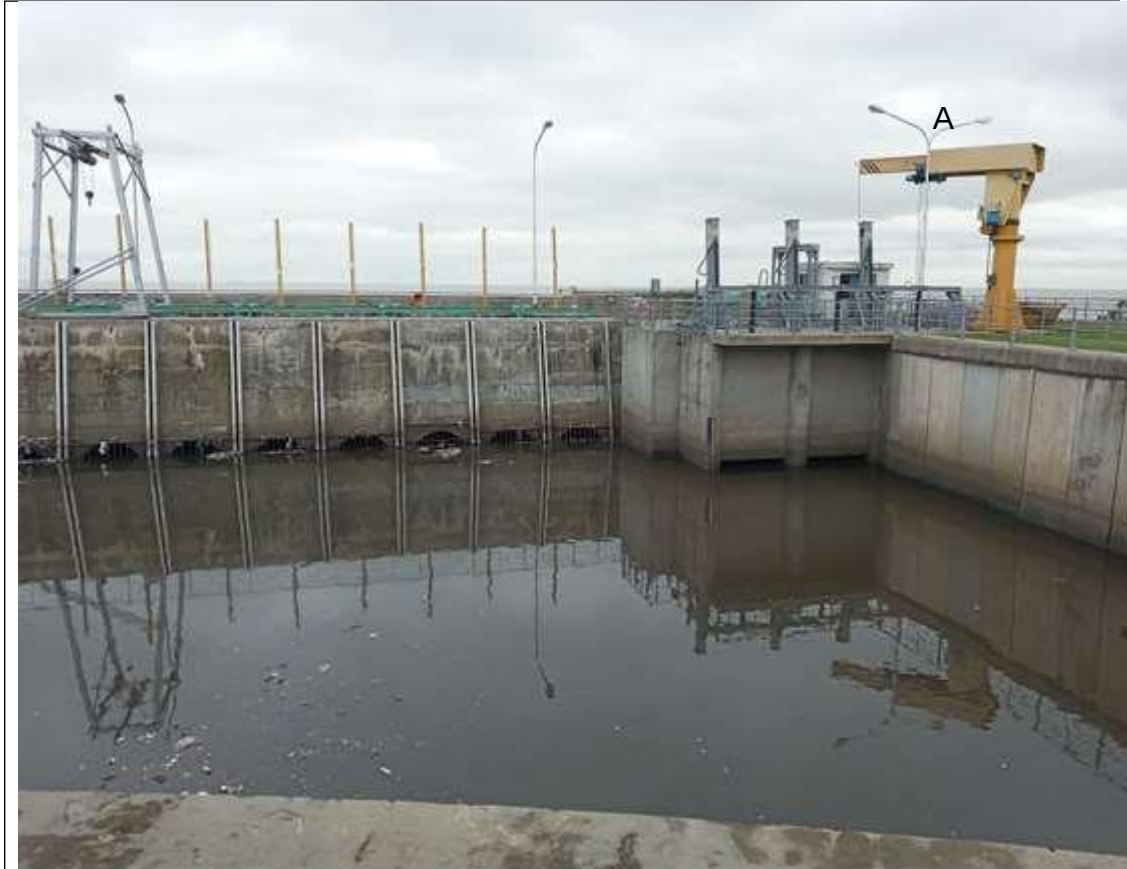
Estación de Bombeo 2 Lado Ramsay. A. Plumas Giratorias, motorizadas por la Puesta en Valor
