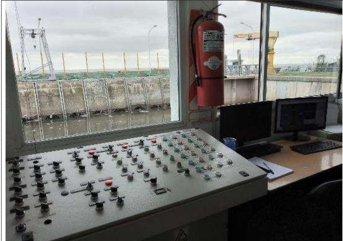
Interior del Centro de Control de la Estación de Bombeo. Consola manual de accionamiento de compuertas y bombas. Monitores del Sistema SCADA para seguimiento y control centralizado (actualizado en la Puesta en Valor).
