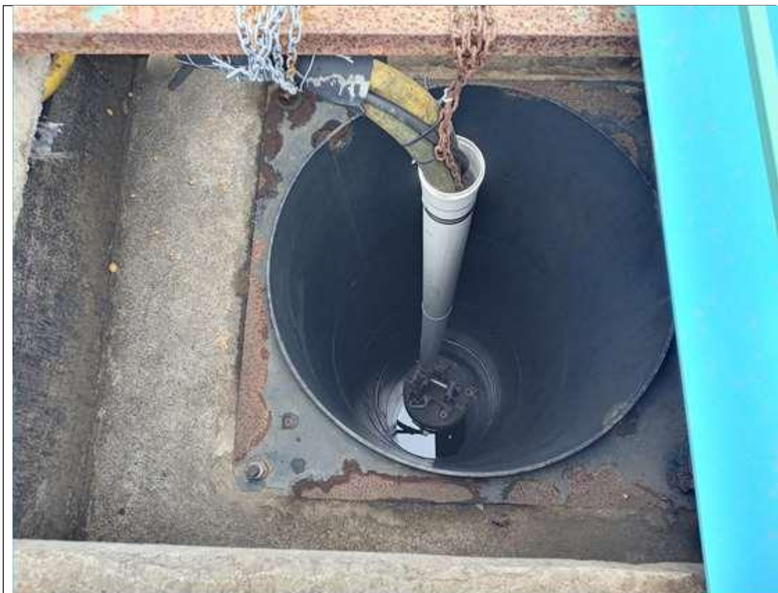
Bomba de 290 Kw Lado River. Actualmente no se encuentra en funcionamiento.
