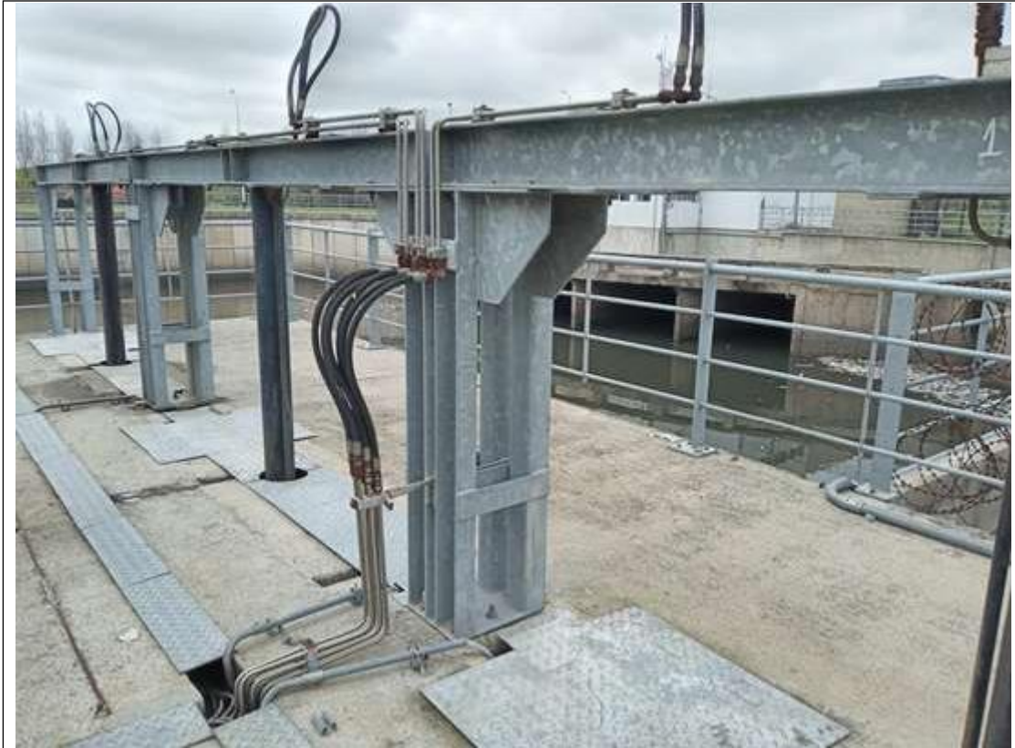
Compuerta 1, 2 y 3 Lado River.
