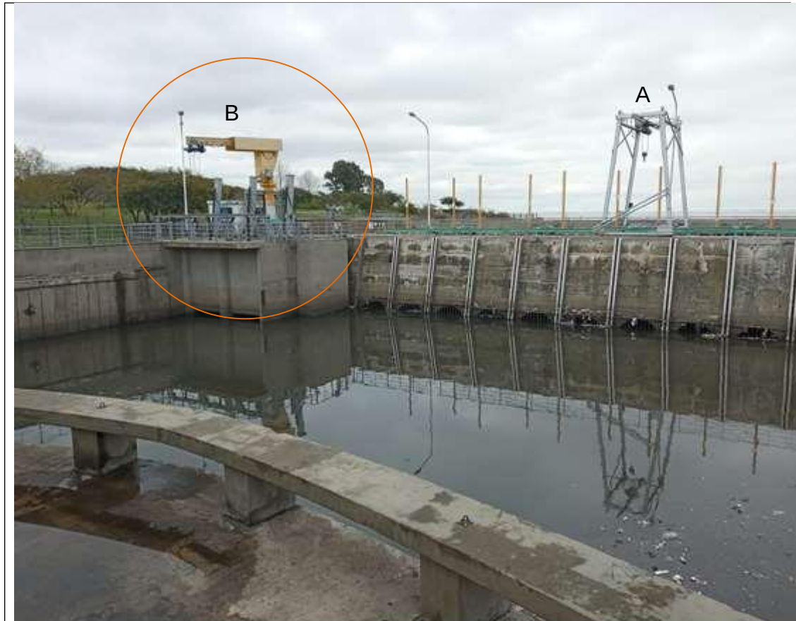
Estación de Bombeo 1 Lado River. A) Grúa Móvil – B) Plumas Giratorias, motorizadas por la Puesta en Valor
