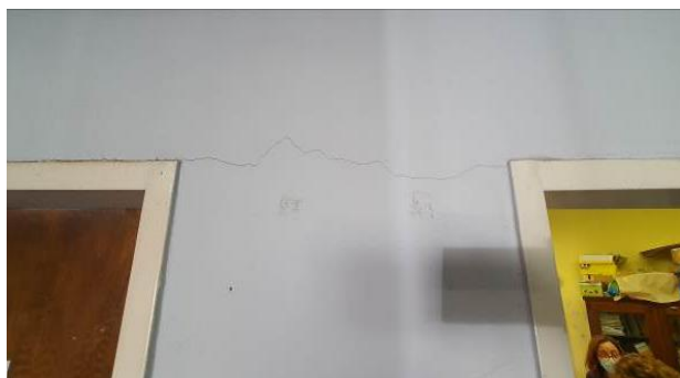
Foto 95 Fisura en puerta de acceso a dirección
