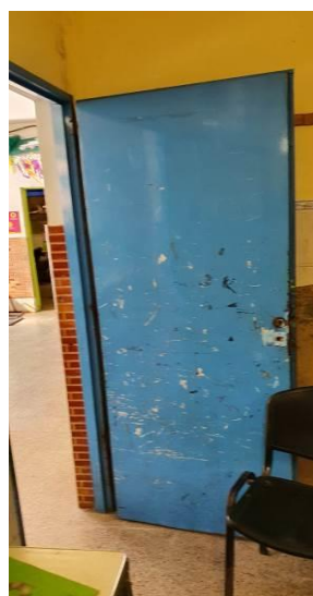
Foto 6 Puertas aulas deterioradas
