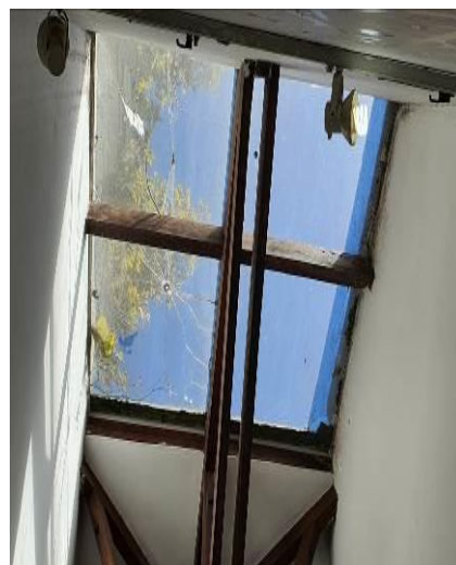
Foto 66 Vidrios rotos sobre escalera
