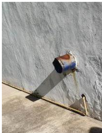
Foto 83 Ventilación estufa TB del SUM
