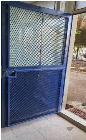
Foto 32 Puerta salida evacuación
