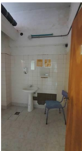
Foto 89 faltantes de cerámicas
