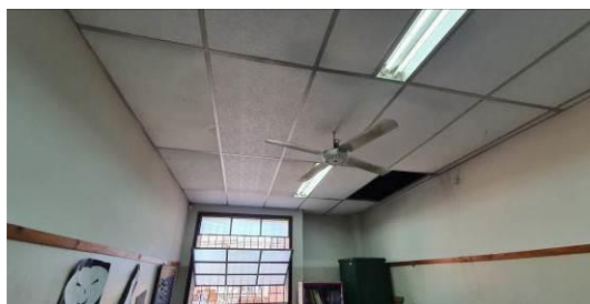
Foto 21 Faltantes en cielorraso en Aula de Computación
