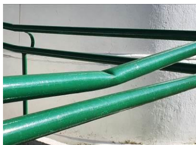
Foto 61 Rampa de acceso golpeada
