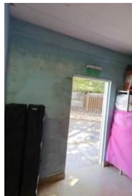
Foto 78 Humedad en pared del SUM
