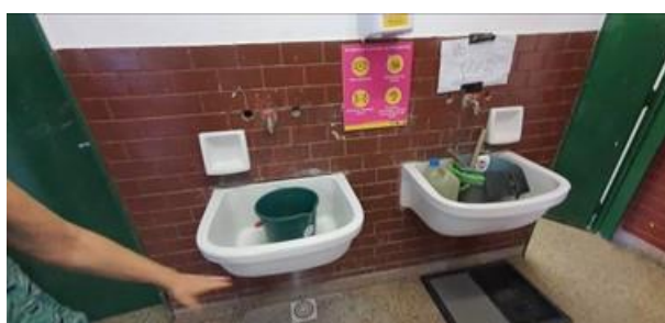
Foto 27 Piletas de baño compartidas, una sin funcionar
