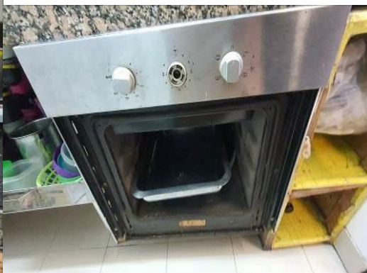
Foto 54 Horno con faltantes y sin funcionar
