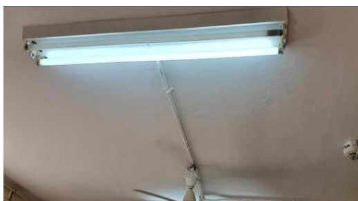
Foto 15 Luminarias sin protección adecuada
