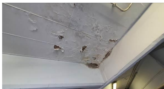
Foto 74 Humedad en techo hall de acceso
