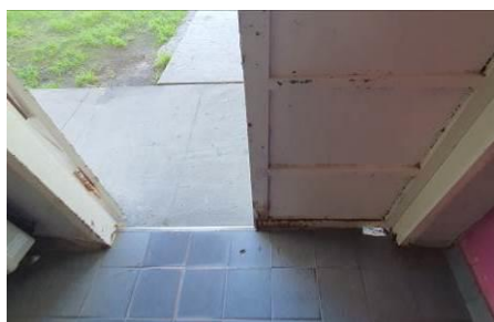
Foto 79 Óxido puerta acceso principal
