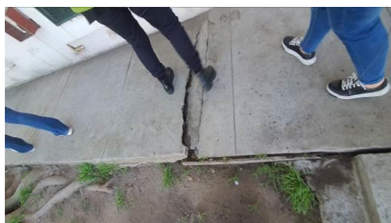
Foto 98 Carpeta rota en camino perimetral al edificio
