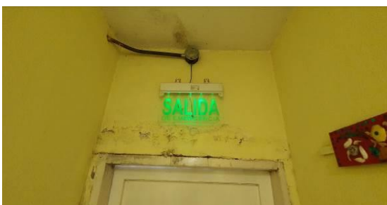
Foto 76 Humedad en salida de emergencia
