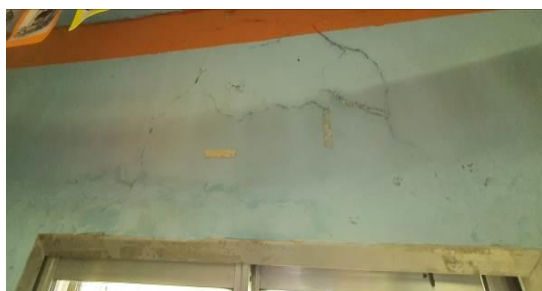
Foto 73 Humedad en pared de SUM
