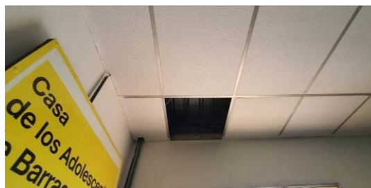
Foto 20 Faltantes en cielorraso en Hall de acceso
