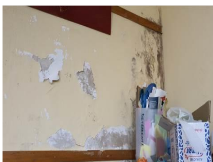
Foto 9 Humedad en Aula 2
