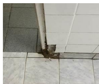
Foto 81 Óxido en marco del baño.
