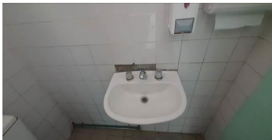
Foto 40 cerámicos faltantes del baño de los niños
