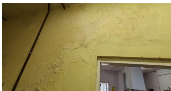
Foto 75 Humedad en pared de acceso a aula 1
