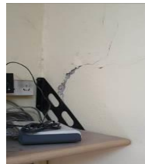
Foto 10 Fisuras en Biblioteca
