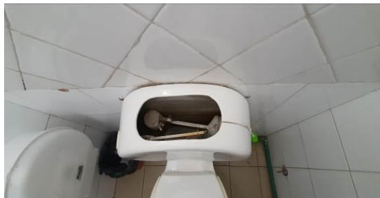
Foto 38 mochila del inodoro del baño de personal.
