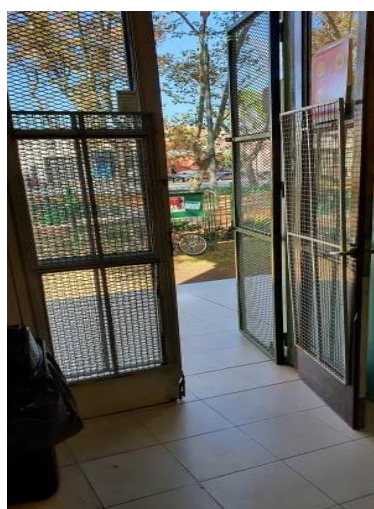
Foto 51 Salida de evacuación
