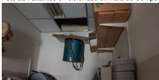
Foto 23 Faltantes en cielorraso en Deposito de dirección
