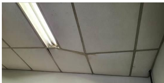
Foto 19 Cielorraso caído en dirección
