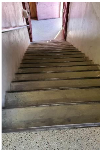
Foto16 Escalera de Acceso deficiente
