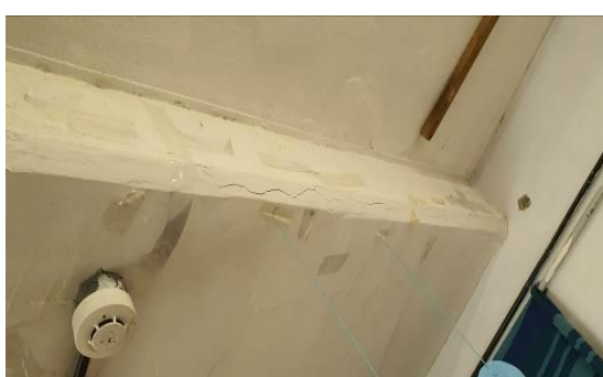
Foto 96 Fisura en techo de aula 1
