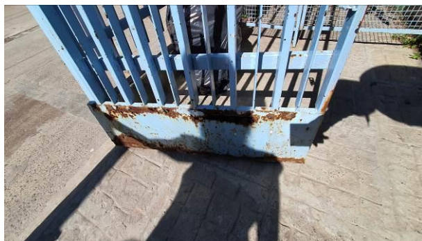
Foto 7 Reja de Acceso oxidada
