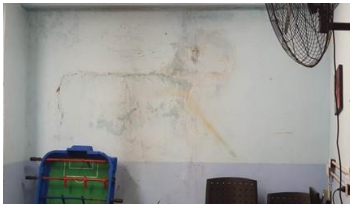
Foto 77 Humedad en pared del SUM
