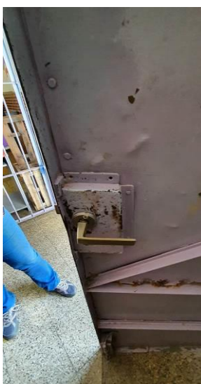
Foto 4 Puerta de acceso oxidada.
