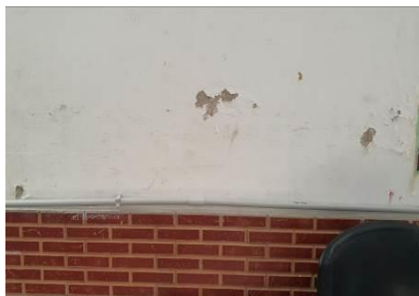
Foto 8 Humedad en Aula 1
