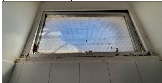
Foto 37 Ventana oxidada Baños
