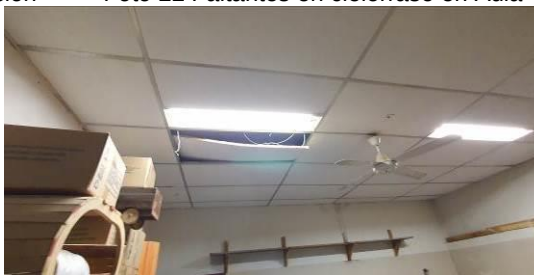
Foto 24 Faltantes en cielorraso en Taller de Carpintería
