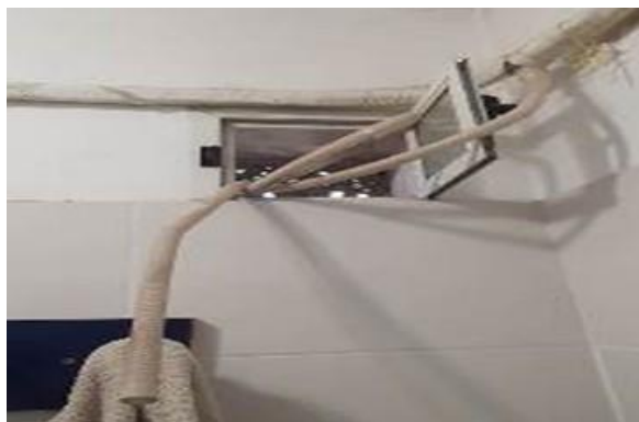
Foto 57 Caño de aire acondicionado en baño suelto
