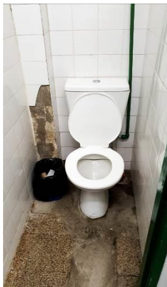
Foto 12 Faltantes de cerámicos
