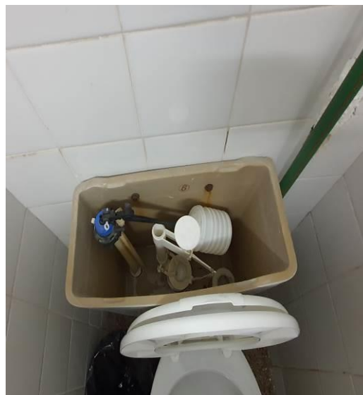
Foto 13 Mochila con pérdidas y sin tapa
