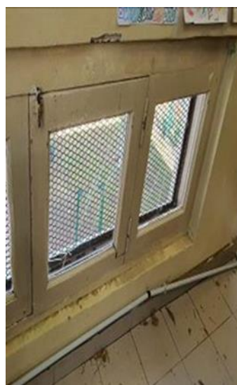
Foto 56 con ventanas de apertura hacia adentro, vidrios rotos.
