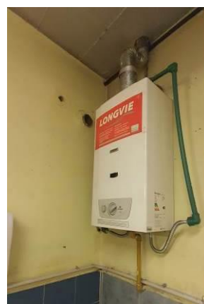
Foto 84 Calefón en la cocina
