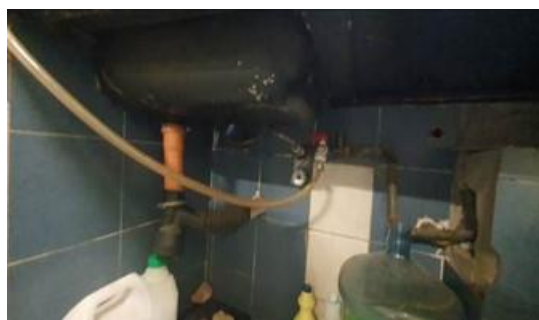
Foto 86 Conexiones de agua y cloacales
