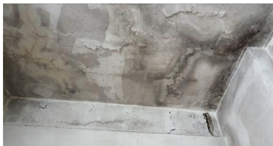
Foto 69 Humedad en depósito del aula 1.
