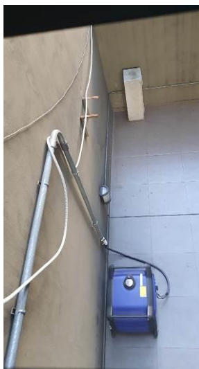
Grupo electrógeno en 1° P
