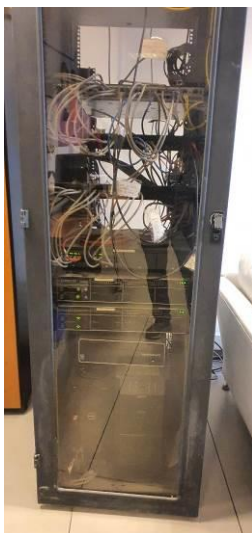
Rack del servidor
