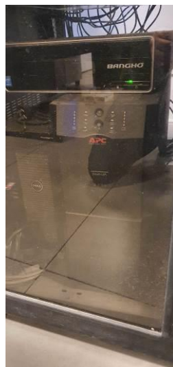
UPS del Servidor
