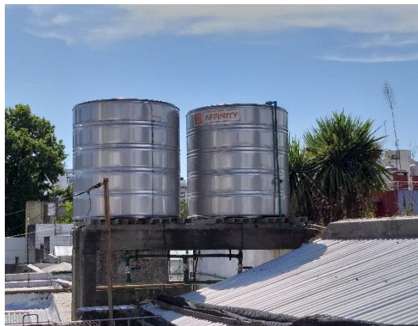
Obs.: Incumplimiento del PET en lo que respecta a los trabajos de pintura
