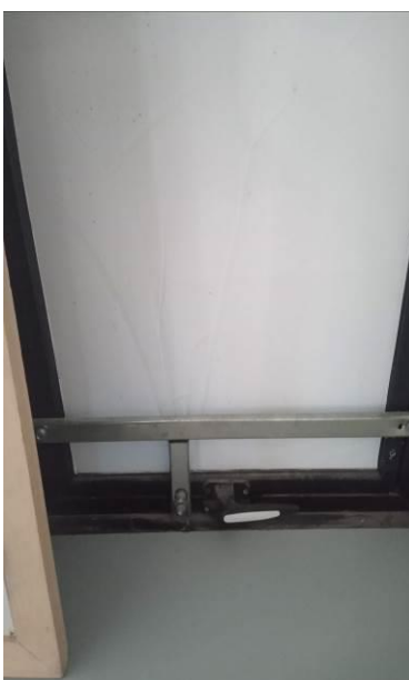
Vidrio roto y bloqueada la apertura
