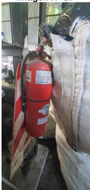
Matafuego obstruido por acopio
