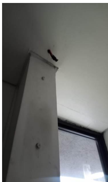
Luces de emergencia desconectadas
