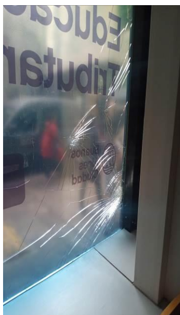
Vidrio roto al frente de la oficina
