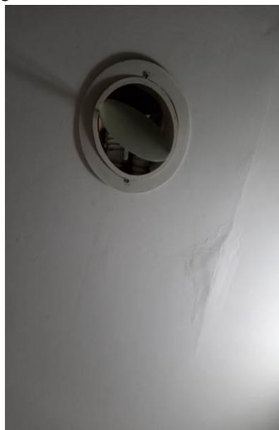
Vidrio de artefacto de luz mal instalada
