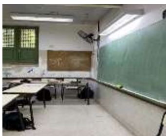
Aula de dimensiones reducidas Con escasa iluminación y ventilación natural
