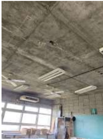
Filtraciones en varios sectores del 1° piso.
