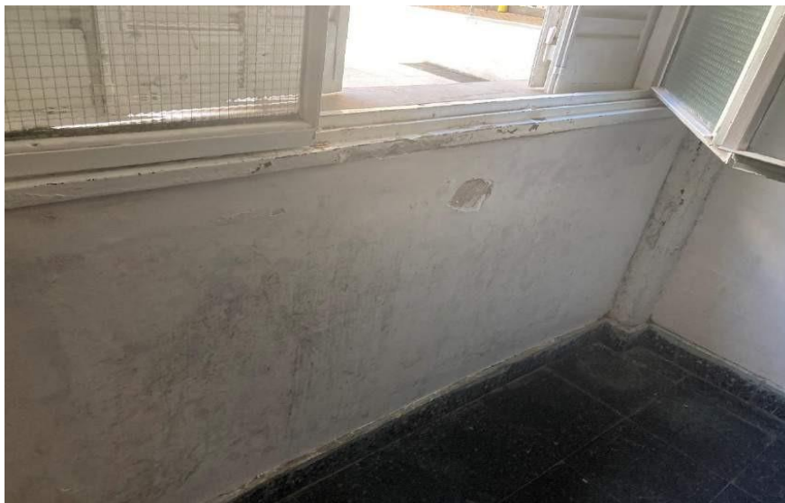
Foto 13: Observación 17: Inundación en aulas
