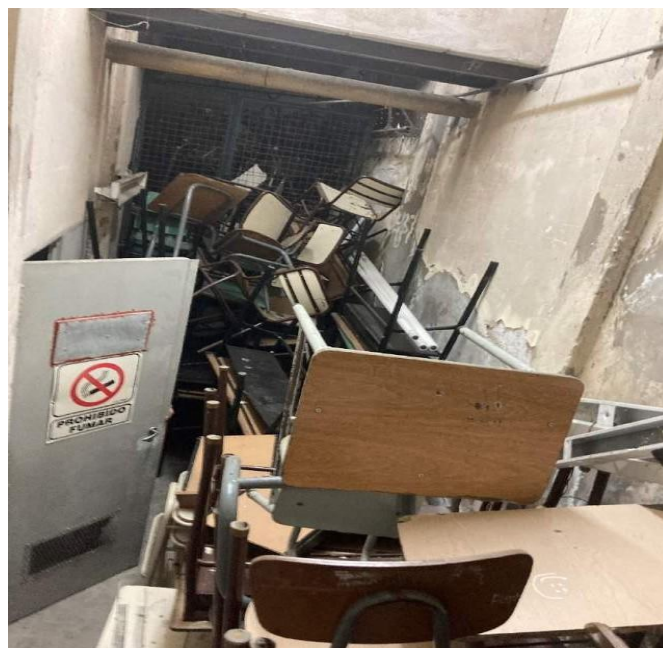
Fotos 42 y 43: Observación 17: Escalera de acceso a sala de gas obstruida y materiales acumulados en espacios de uso.
