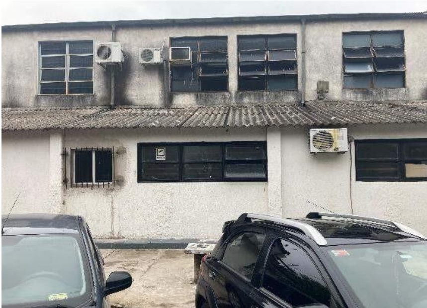
Foto 63: Observación 17: Techo de fibrocemento con asbestos
