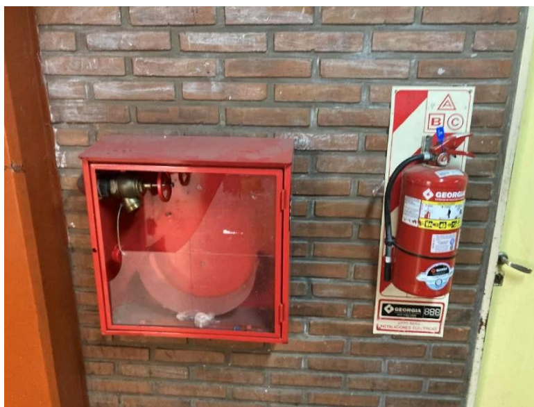
Foto 59: Observación 17: Falta manguera y lanza de incendio, con cristal roto
