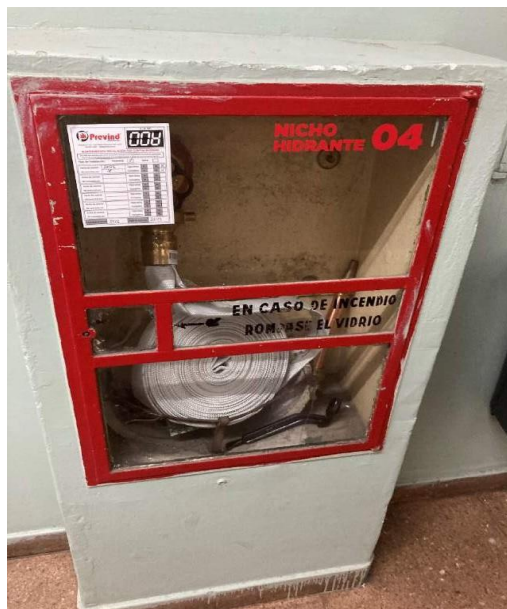
Foto 41: Observación 17: Nichos hidrantes sin agua
