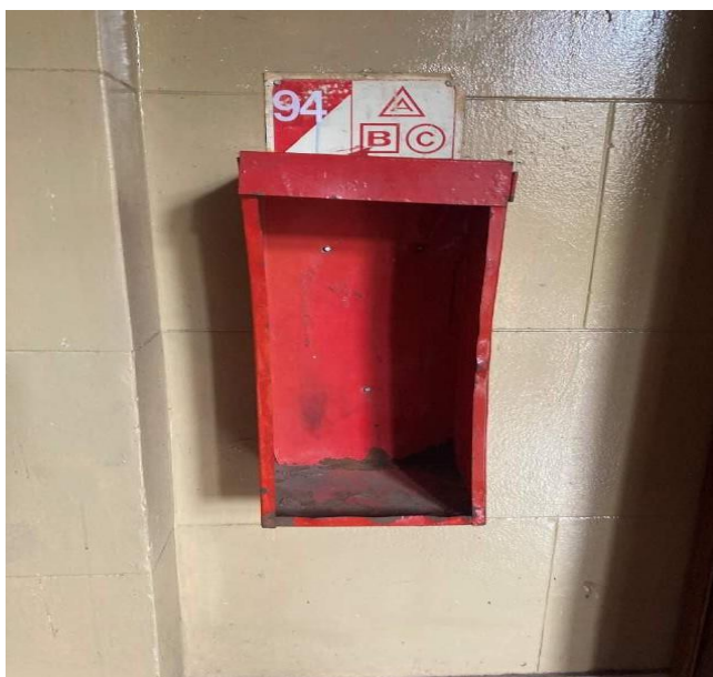
Foto 58: Observación 17: Ausencia de matafuegos en distintas áreas
