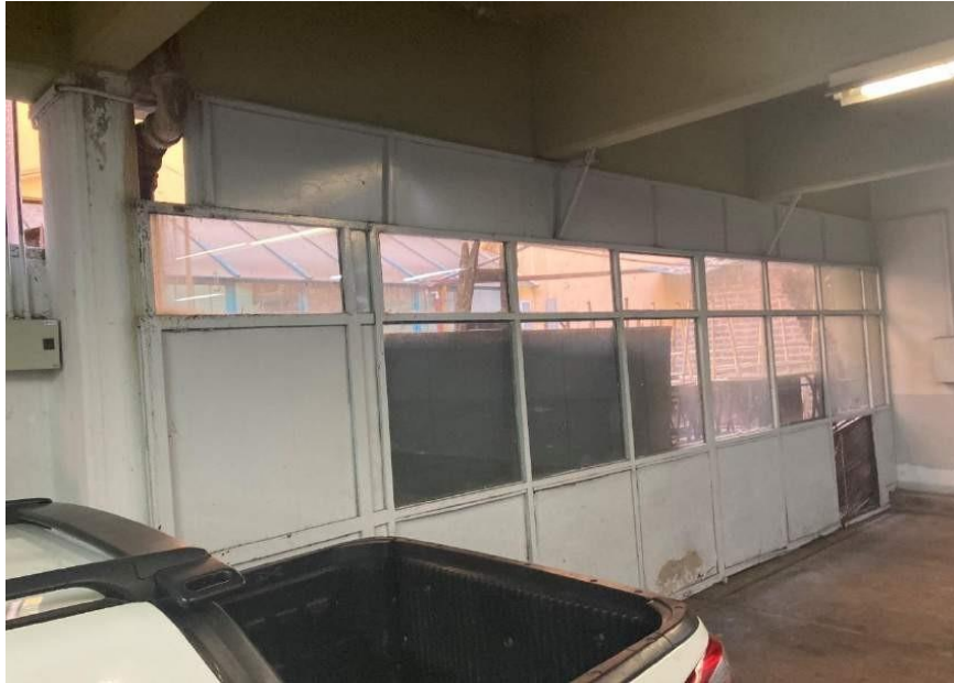
Foto 12.1: Observación 17: Cerramiento irregular en subsuelo.
