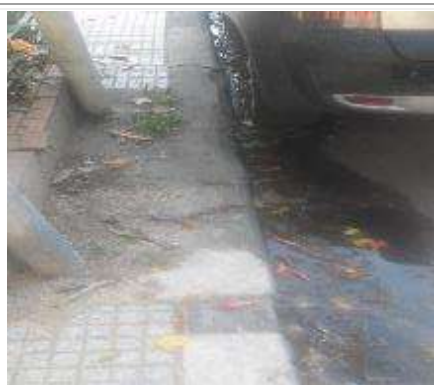
FOTO N° 49: Defectuosa terminación de la vereda
