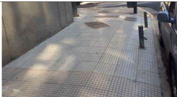
FOTO N° 8: Foto obtenida por la Inspección de obra (Año 2020)
