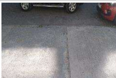
FOTO N° 36: Falta junta de dilatación
