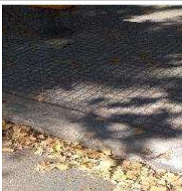
FOTO N° 44: Vereda nueva con falta de junta de dilatación
