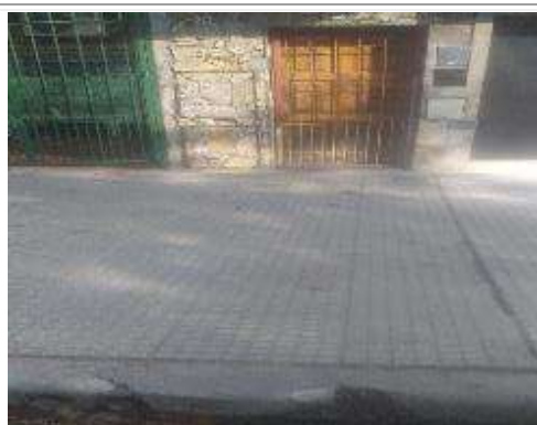
FOTO N° 50: Junta de dilatación faltante
