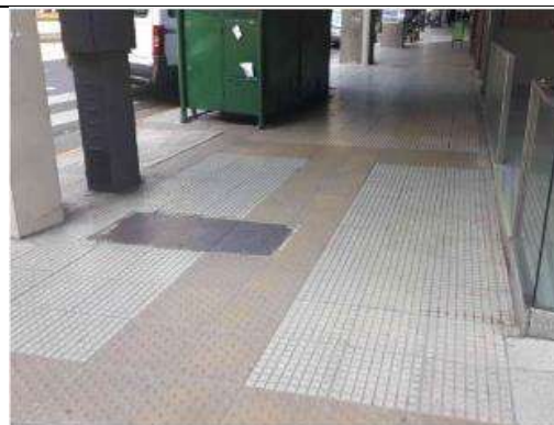
FOTO N° 7: Foto obtenida por la Inspección de obra (Año 2020)
