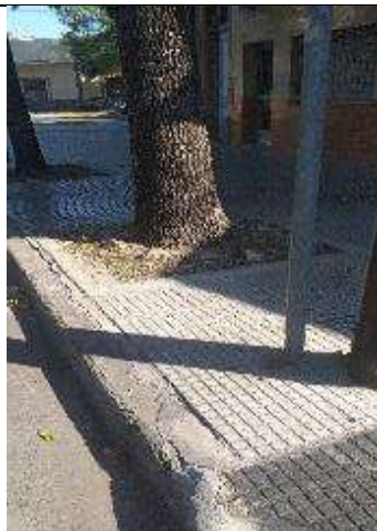
FOTO N° 34: Cordón sin junta de dilatación
