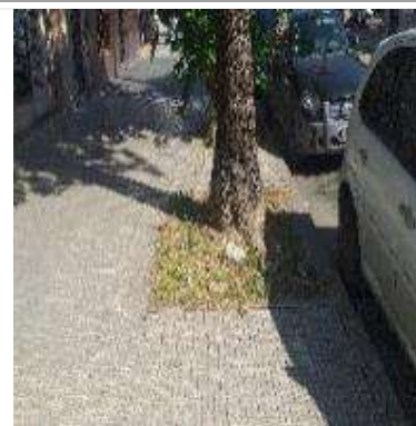
FOTO N° 43 Falta de junta de dilatación con el cordón
