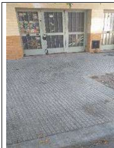
FOTO N° 33: Frente de vivienda con falta de juntas de dilatación
