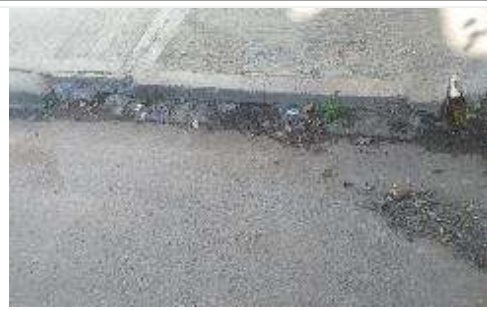
FOTO N° 39: Falta de cordón
