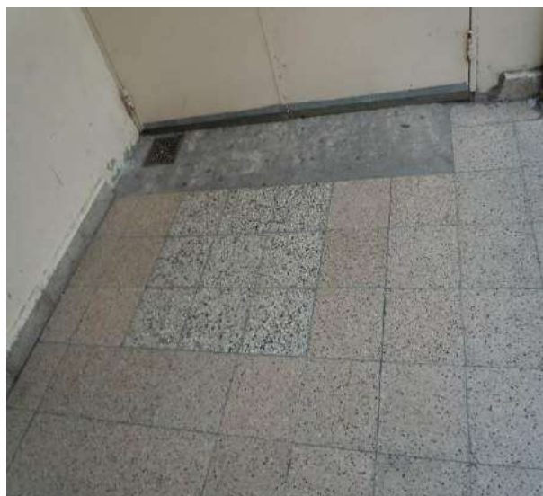
Falta de reposición de mosaicos/zocalos.
