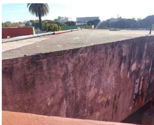
Tanque de agua del complejo sin mantenimiento preventivo.
