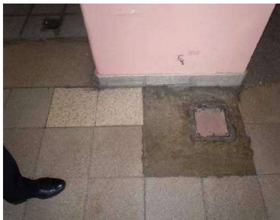
Parche en cemento. Reponer baldosas. Falta volante.
