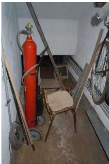
Elementos en sala de bombas
