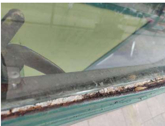
Oxidación de marco por falta de sellado.
