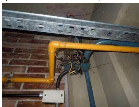
Cableado eléctrico expuesto cercano a red de gas.
