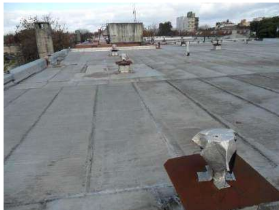
Sombretes tapados con membrana. Deben Repararse o reemplazarse.
