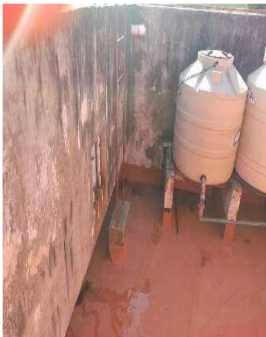
Pérdida de agua
