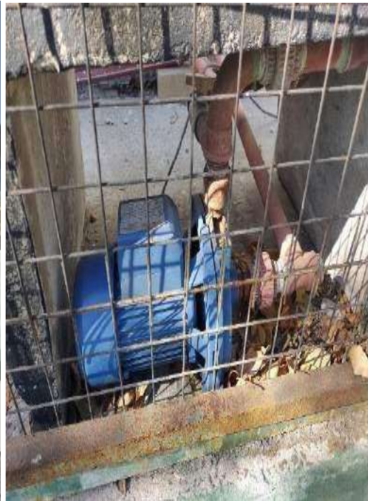
Bomba de agua. Cañerías plásticas sin protección solar
