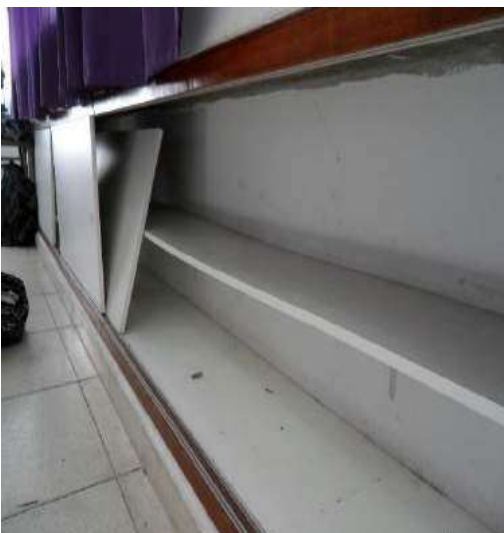
Mobiliario fijo sin mantenimiento.
