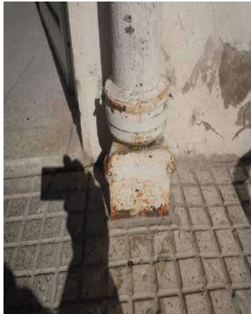
Boca de limpieza inutilizada por mala construcción. Nivel inadecuado.
