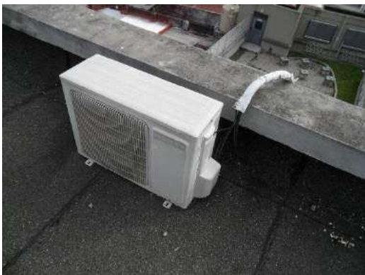
Unidad exterior de AA apoyada sobre membrana hidrófuga.
