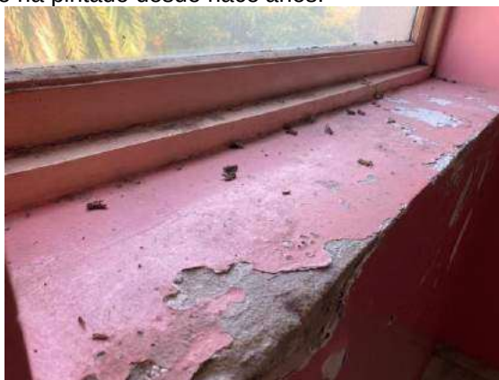
Insectos, suciedad, falta de pintura.
