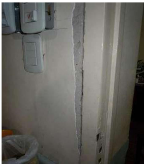
Desprendimiento de revoque
