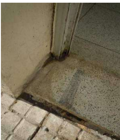
Solado marcado por caída de la puerta.
