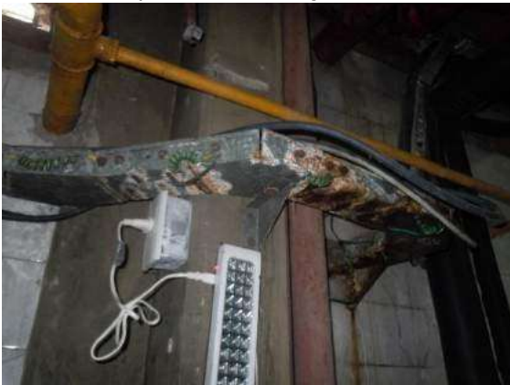
Bandeja eléctrica afectada por filtración PB.
