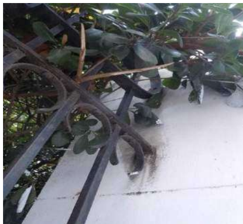
Trabajo de pintura mal ejecutado
