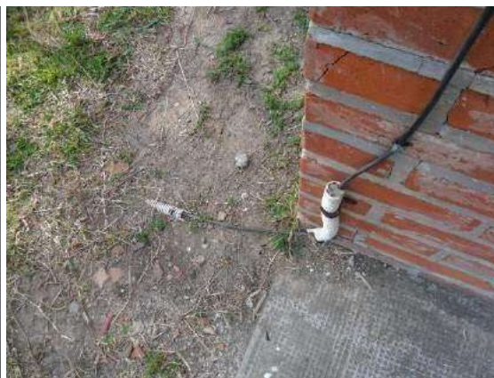
Cable expuesto en el piso. Solucionado entre el relevamiento y el descargo.
