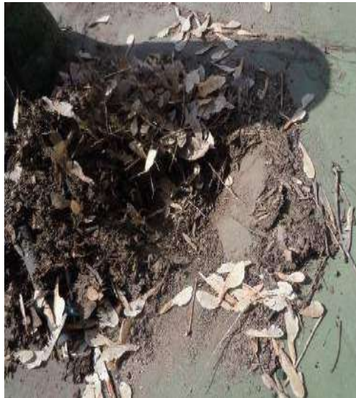
Embudos desagote bloqueados de barro.
