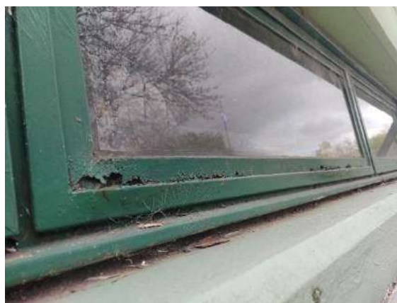
Oxidación de ventanas por falta de mantenimiento.
