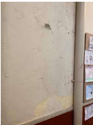
Pintura reseca y despegada
