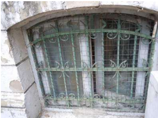
Abertura sin mantenimiento
