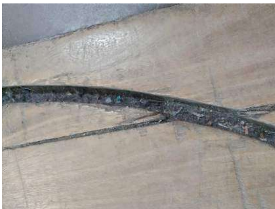
Falta mantenimiento en guía de puerta salón de música.
