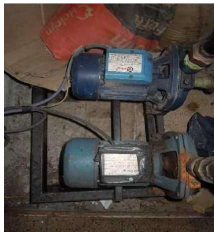
Bombas. Presencia de oxido. Materiales
