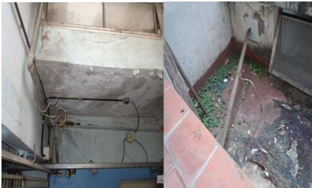
Filtraciones generalizadas en techado agregado sobre PB.
