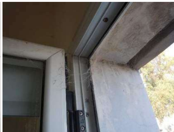
Aberturas con telaraña sin mantenimiento
