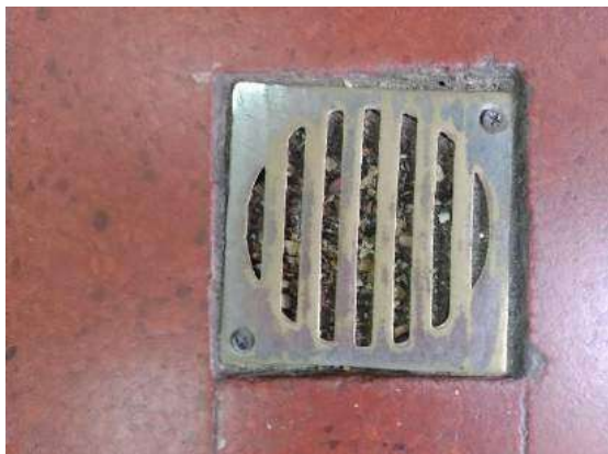
Rejilla tapada sin mantenimiento.
