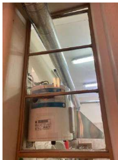
Termotanque impide ventilación
