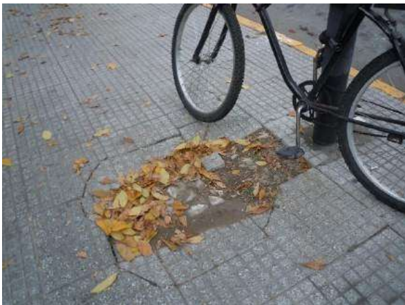
Hundimiento en vereda.
