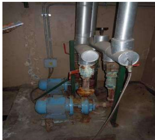
Presencia de óxido en bombas de
