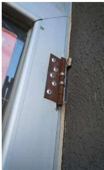
Reemplazo de bisagras, presencia de óxido
