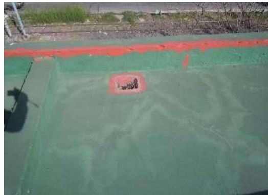
Precariedad del trabajo anterior realizado de impermeabilización. Faltan rejillas.
