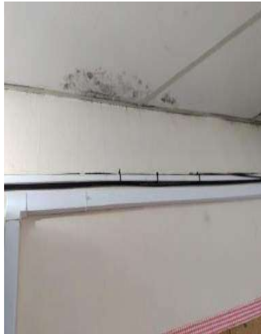
Humedad en cielorraso. Chorreadura. Hongos
