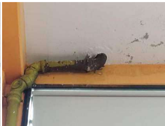
Pluvial tapado por falta de mantenimiento
