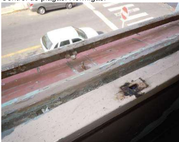
Falta de mantenimiento de aberturas. calefacción. Presencia de óxido, falta de lubricación.
