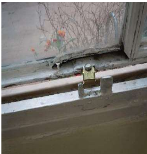
Aberturas, falta brazo y contravidrio
