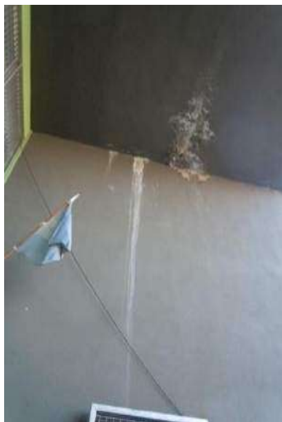
Filtraciones en losa superior acceso
