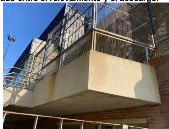
Óxido en fachada por recubrimiento insuficiente
