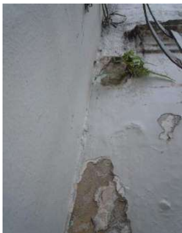
Humedad, vegetación surgente en mampostería.
