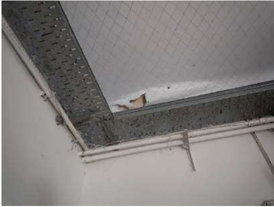
Humedad sobre bandeja, presencia de óxido
