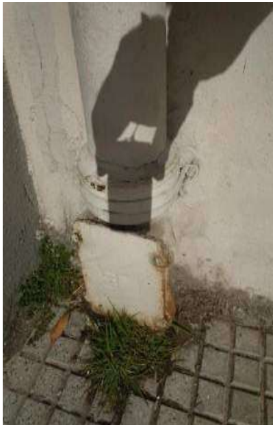
Boca de limpieza inoperable
