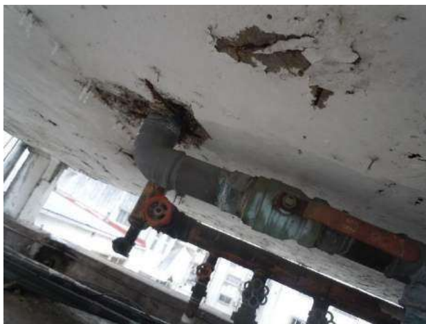
Filtraciones de larga data en tanque de agua. Hierros expuestos. Saltado de recubrimiento. Estalactitas.
