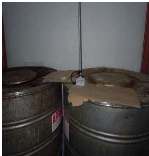
Tanques de agua con presencia de óxido, ausencia de mantenimiento
