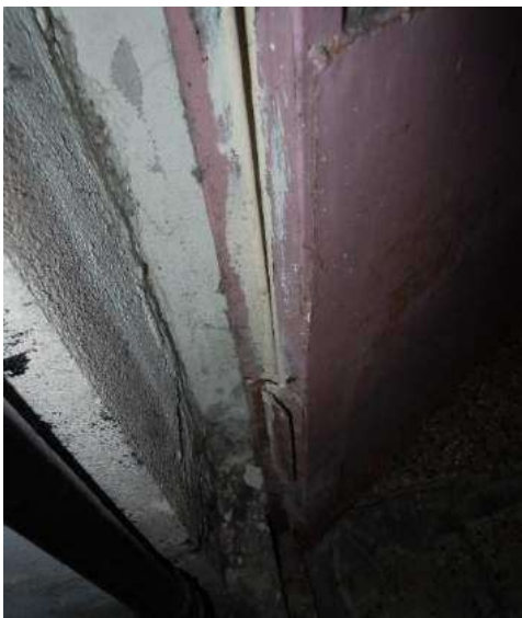
Bisagra rota en puerta sala de máquinas
