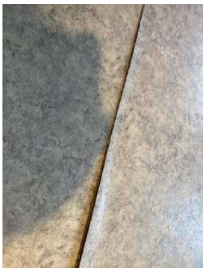
Piso diferente al exigido en proyecto
