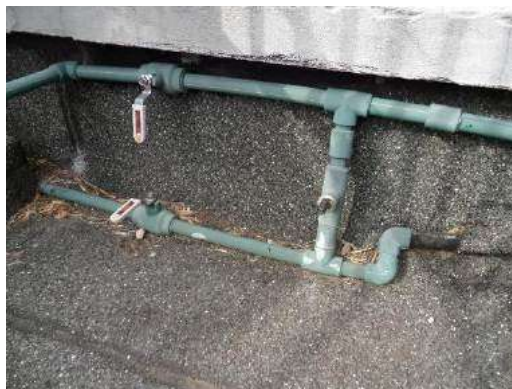
Cañerías plásticas afectadas por falta de protección a la intemperie.
