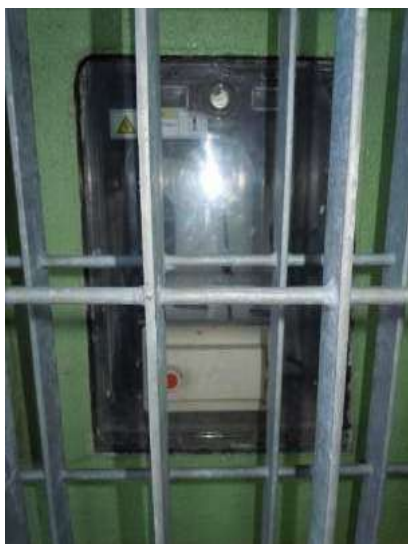
Caja de medidor electricidad vacía
