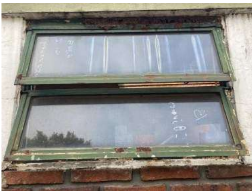
Ventana sin mantenimiento
