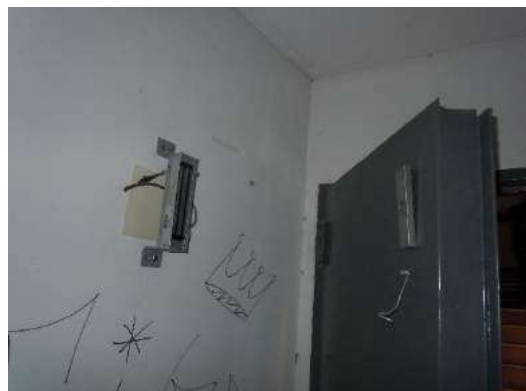
Sistema de fijación magnética de puertas de incendio fuera de servicio.
