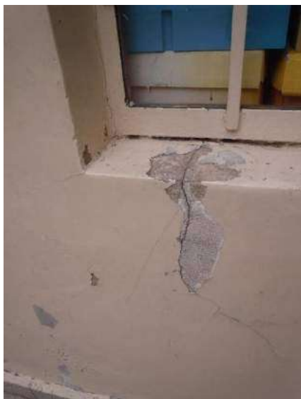
Fisura en pared a reparar.
