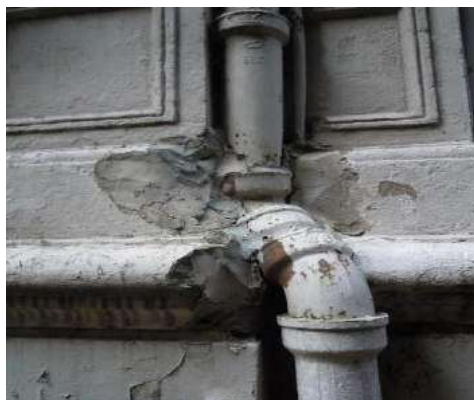
Mala terminación de reparación efectuada
