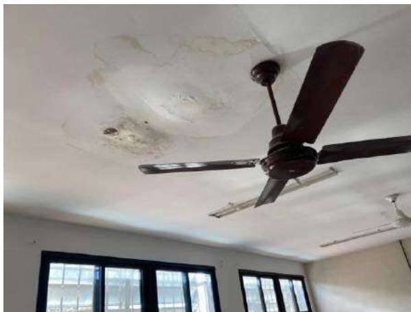
Filtraciones en el techo. Placas de yeso hinchadas
