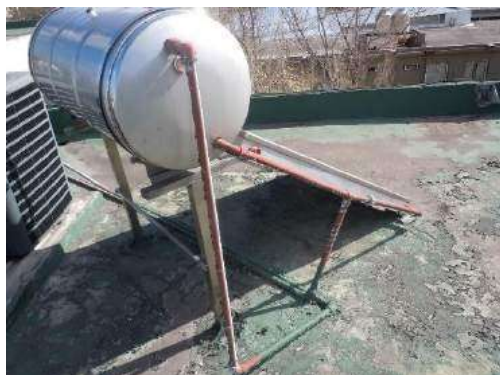
Revestimiento de cañerías quemado. Pintura hidrofuga desprendida.
