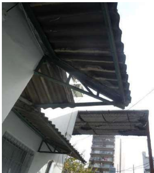
Galerías con fibrocemento. Asbesto.
