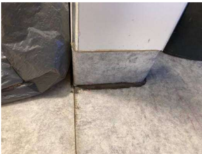
Malas terminaciones en la colocación del piso
