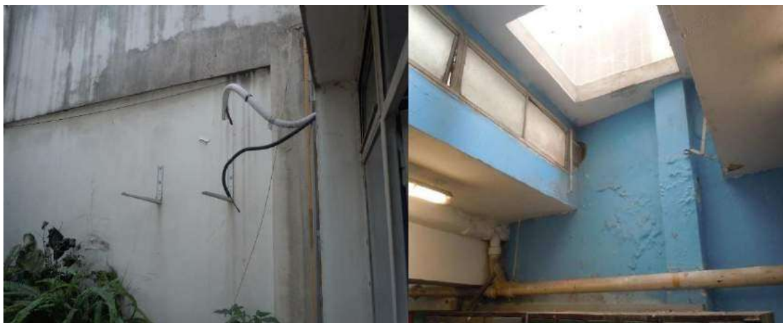
Falta equipo de AA en primer piso
