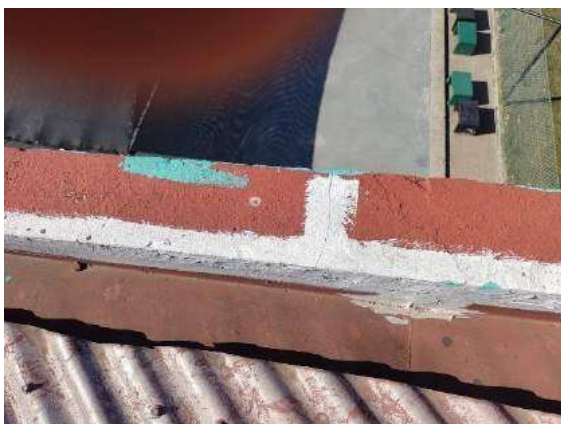
Detalle fisura en muro de carga y canaleta.
