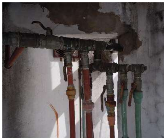
Filtración en base de tanque
