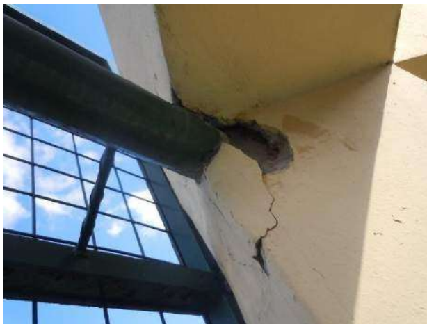
Fisura/desprendimiento en anclaje.
