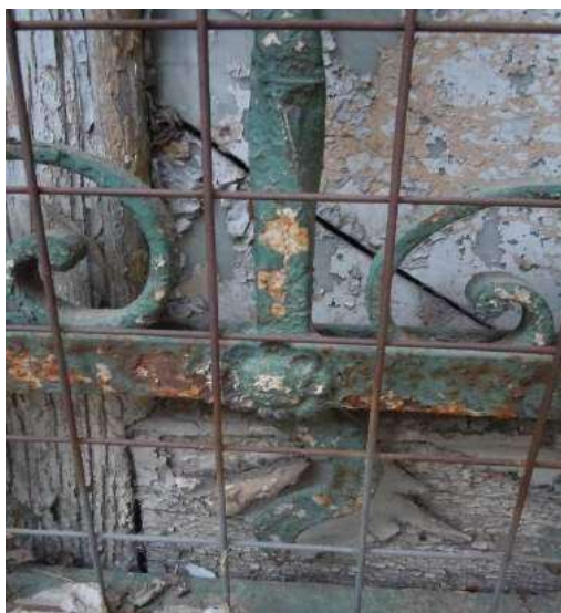
Ventana y reja sin mantenimiento, vidrio roto.
