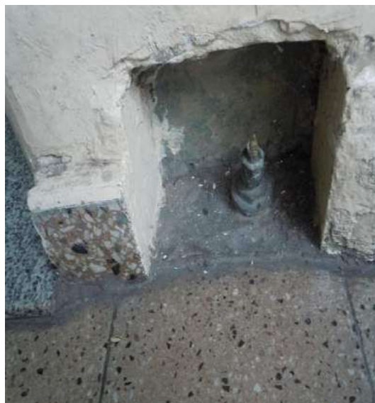
Llave de paso rota. Falta volante.
