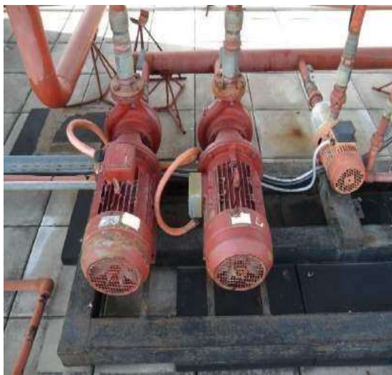
Presencia de óxido en bombas.
