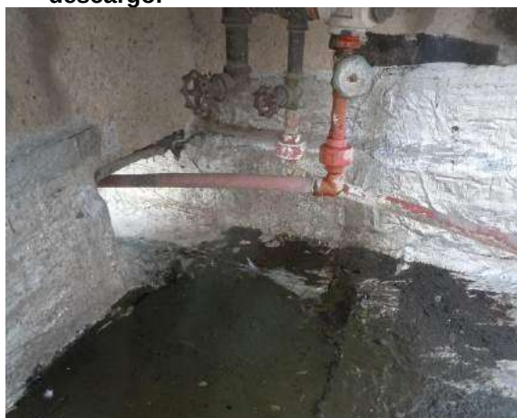
Pérdida en colector tanque. Caños sin protección
