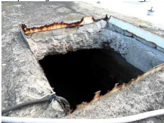
Falta tapa tanque. Marco deteriorado
