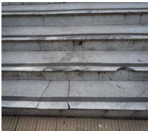
Escalones de mármol rotos.
