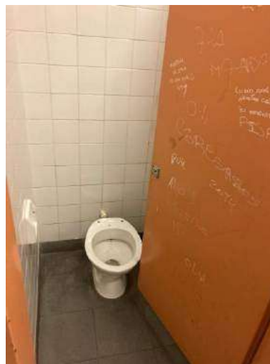
Faltan tapas y asientos en baños
