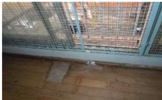
Abertura de mala calidad. Pisos y zócalos afectados por el agua.
