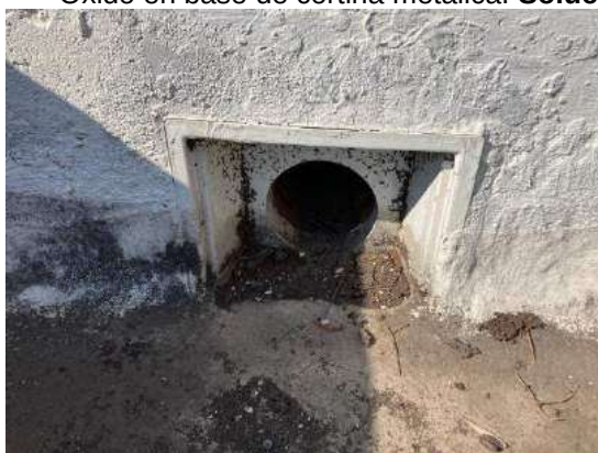
Falta de rejilla
