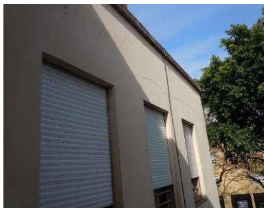
Trabajos de pintura mal ejecutados. Fisura horizontal losa terraza. Recambio de
