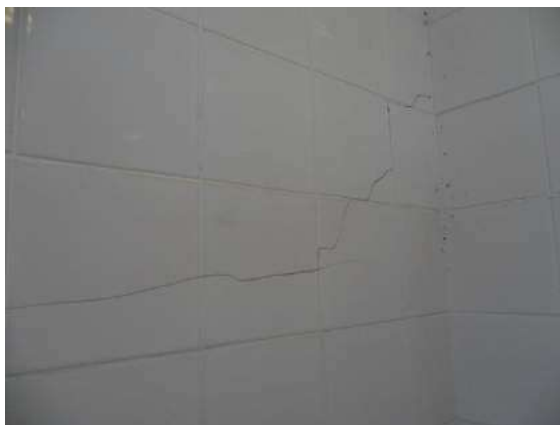
Pared afectada por rajadura. Solucionado entre el relevamiento y el descargo. Fotos: 530
