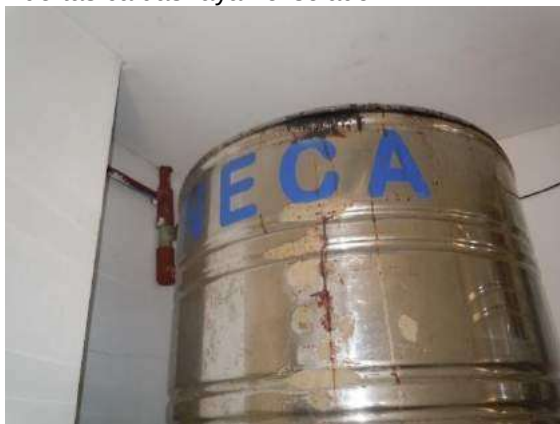
Tanque con oxidación
