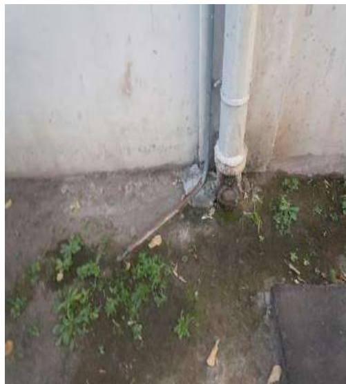
Cañería eléctrica subterránea con cable expuesto.
