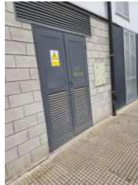
CAMARAS PARA TRANSFORMADORES LOSETAS VEREDA
