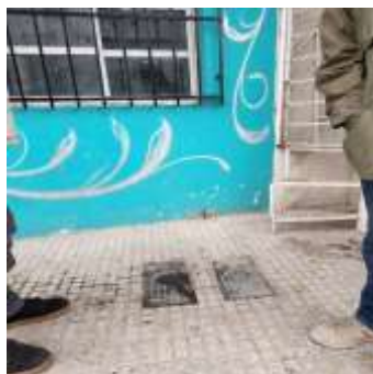
RED AGUA POTABLE
