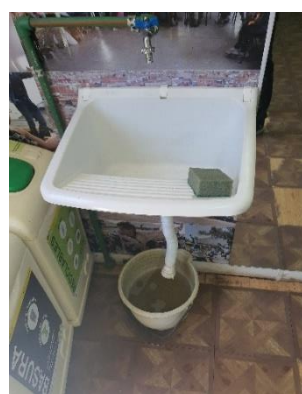
Pileta en el acceso sin cloaca
