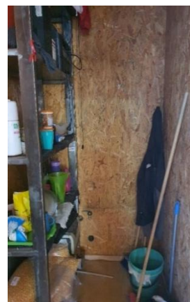
Conexiones sanitarias sin usar
