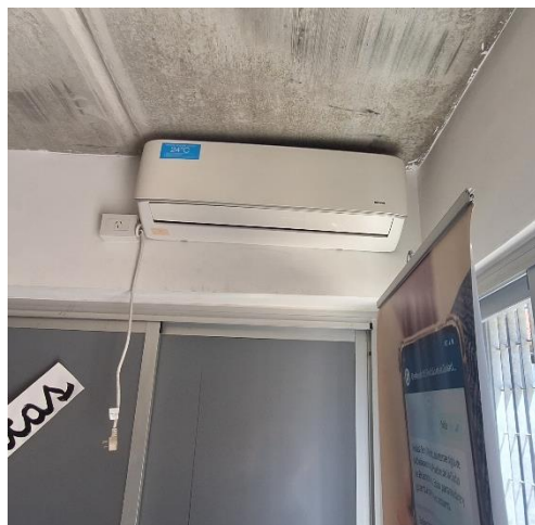
Split aire frío calor sin funcionar
