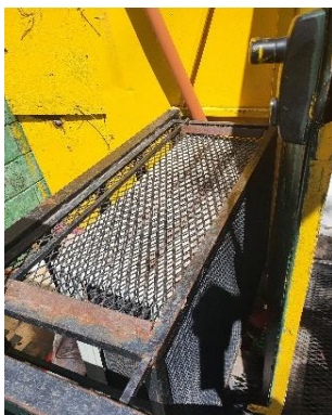
Unidad split desconectada
