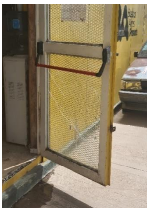
Vidrio roto en puerta de Acceso
