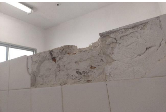
Rotura de pared y faltan azulejos en el baño.
