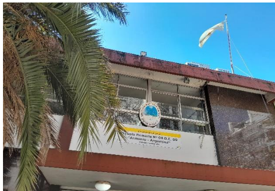
Viga hierro expuesto en frente, desprendimiento
