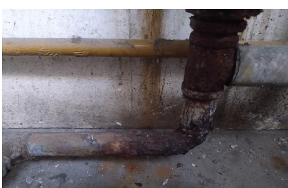
Falta de mantenimiento en cañerías
