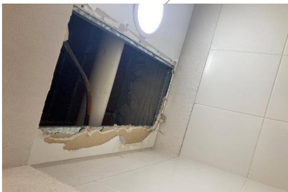
Faltan piezas en cielorrasos
