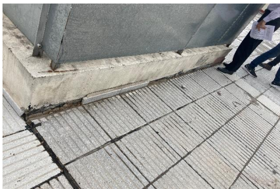
Ferreya: Faltan zócalos y empastinar cubierta
