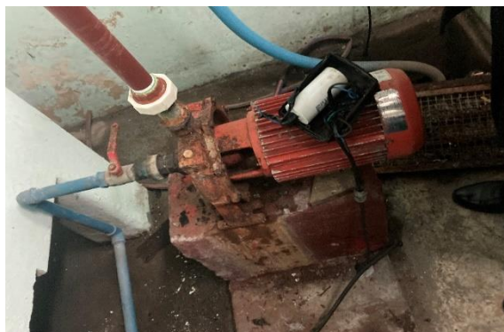
Bomba sin mantenimiento
