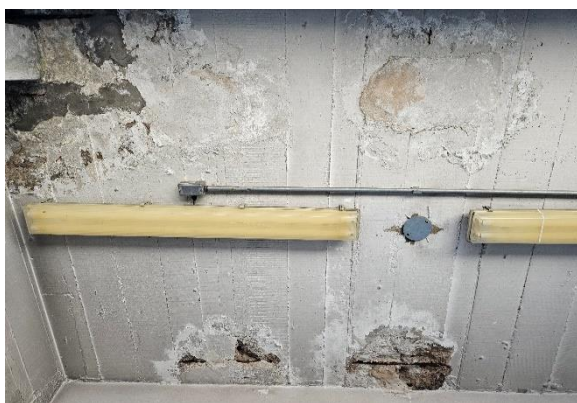
Lautaro: Cielorraso sin mantenimiento
