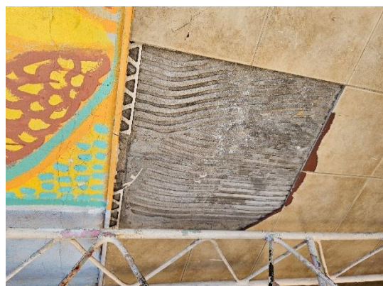
Pared faltan cerámicos
