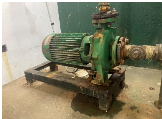
Bombas sin mantenimiento, empaquetaduras
