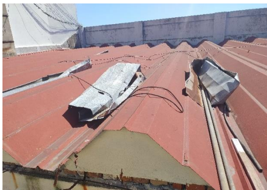
Av. Libertador: Canaleta tirada sobre cubierta
