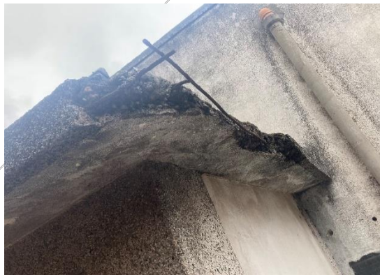
Mampostería falta mantenimiento
