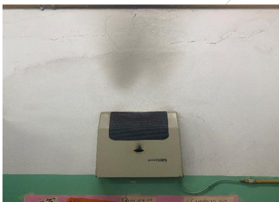
Arias: Falta regulación calefactores
