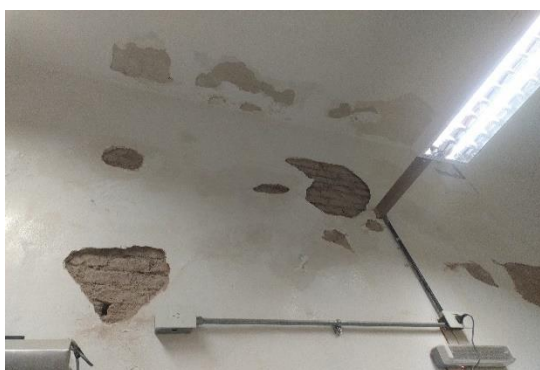
Dantas: Falta de mantenimiento en paredes
