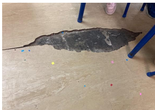
Pisos rotos en aulas
