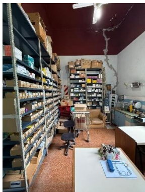
Imagen 1. Sector farmacia, grieta en la pared.
