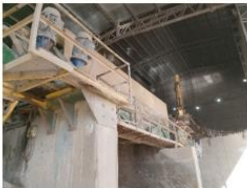
Imagen 15: Motores y reductores, cinta transportadora, separadores magnéticos y por soplado
