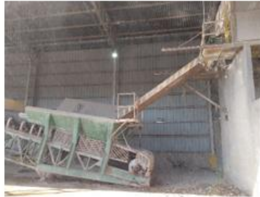
Imagen 19 : Motores y reductores, cinta transportadora, separador magnético
