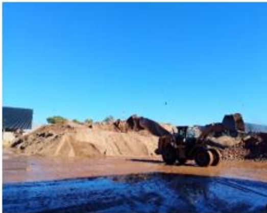
Imagen 28: Zona de acopio y expedición del material procesado
