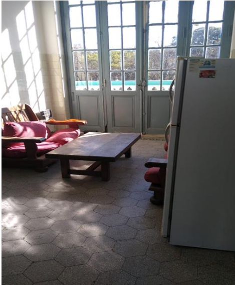
Fotos N° 4,5,y 6 Baños en estado regular y locker en mal estado
