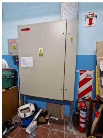
Sala de máquinas (21)
