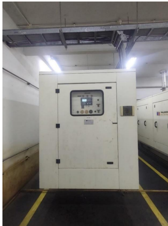
Figura 32 Provisión e instalación de controlador de grupo electrógeno, es en el tablero con visor el adicional
