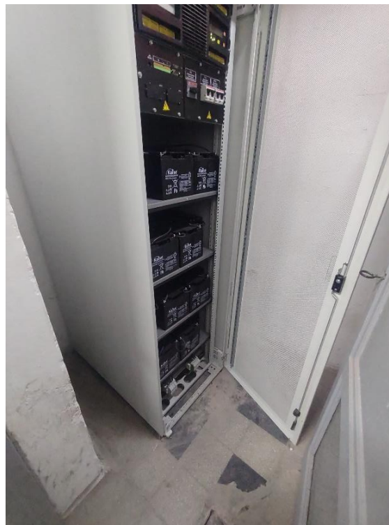
Figura 34 Provisión e instalación de UPS para el sector de Neonatología
