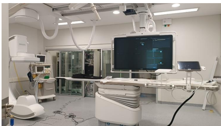
Figura 24 Sala con Equipos en marcha
