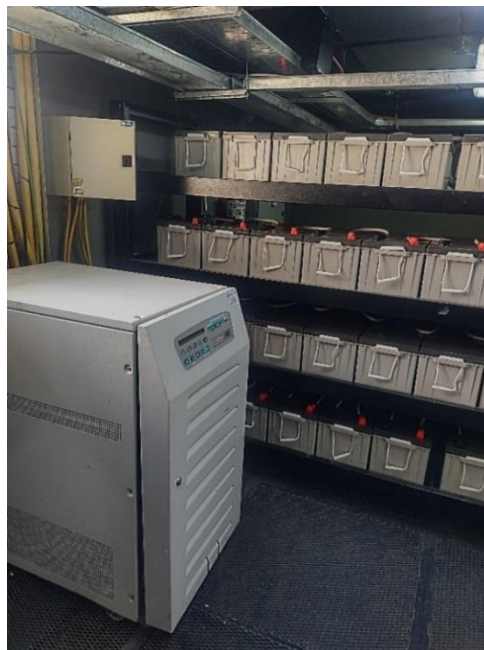
Figura 29: Sector de Baterías de la UPS Pabellón Cobo Imagen de la visita realizada por el equipo de AGCBA 29-08-2025
