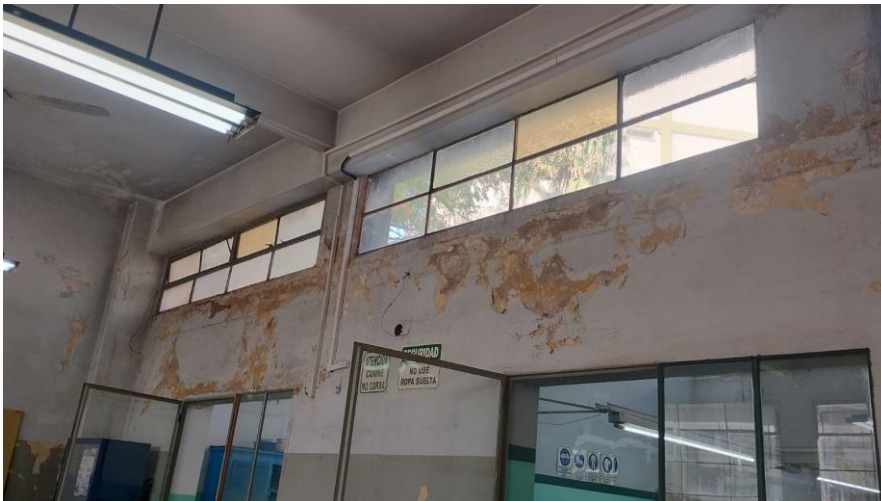
Humedad en muros
