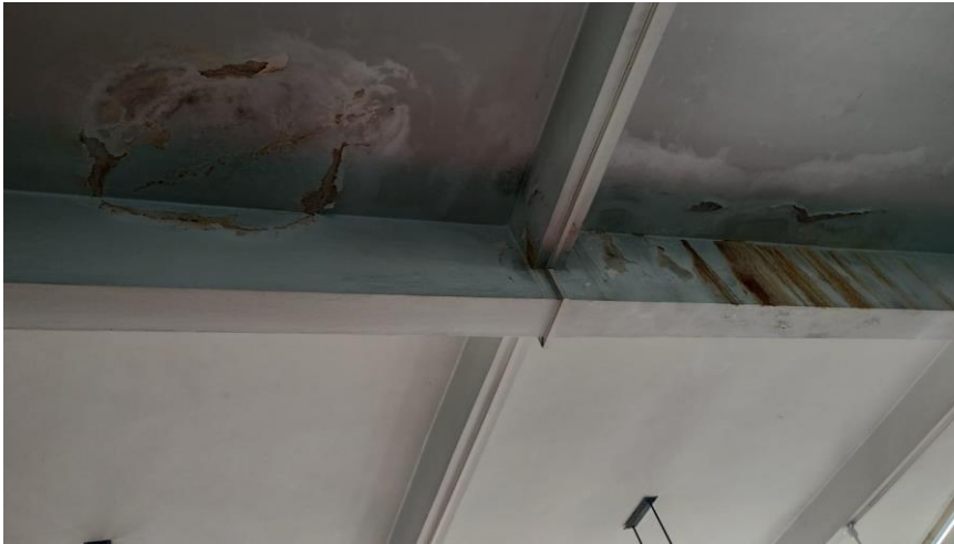
Filtraciones en techos
