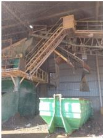
Imagen 20 : motores y reductores, cinta transportadora y separadores
